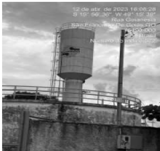
Foto 6 - RAP 1 e REL do CR São Paulo com pintura desgastada.
