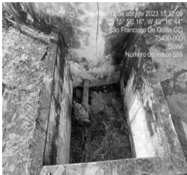
Foto 5 - Caixa de passagem do RA da EEAT Intermediária com ausência de proteção adequada.
