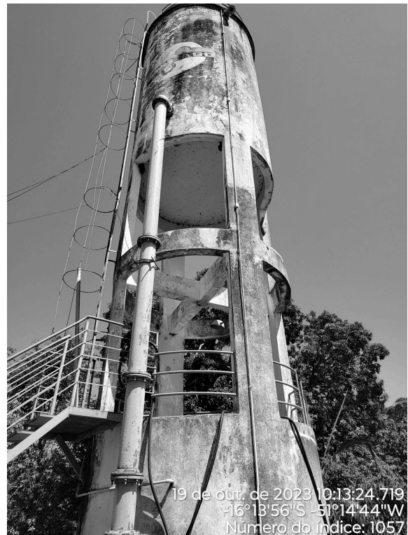
Foto 8 - REL Lavagem de filtro com pintura desgastada.
