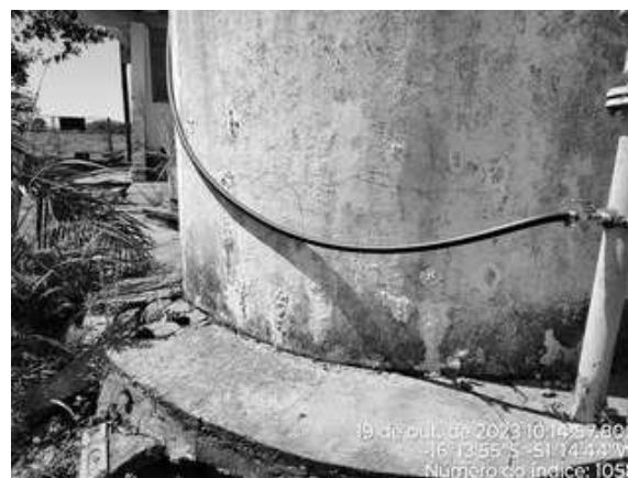
Foto 4 - Eflorescências/infiltrações no filtro russo/filtro rápido.
