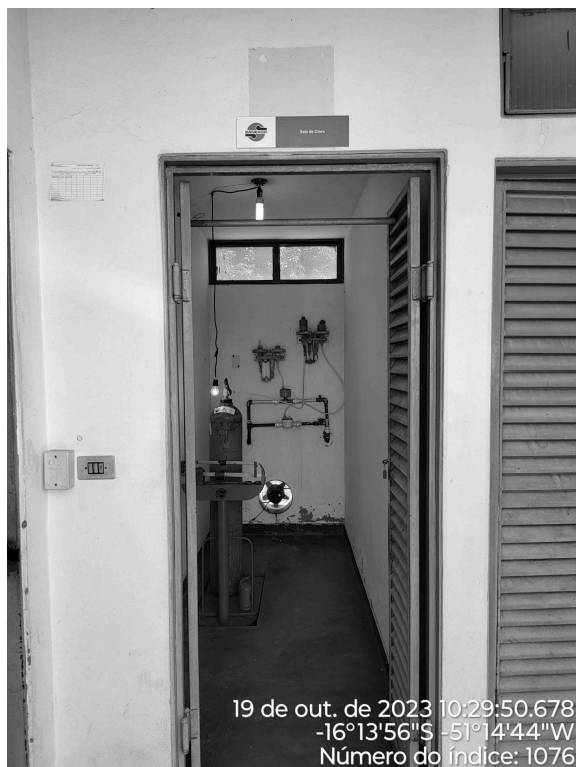
Foto 1 - Sala de cloração sem aviso de advertência da área de risco.
