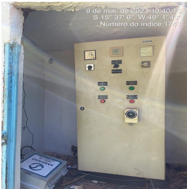
Foto 1 - Ausência de aviso de risco no quadro de comando do poço P2
