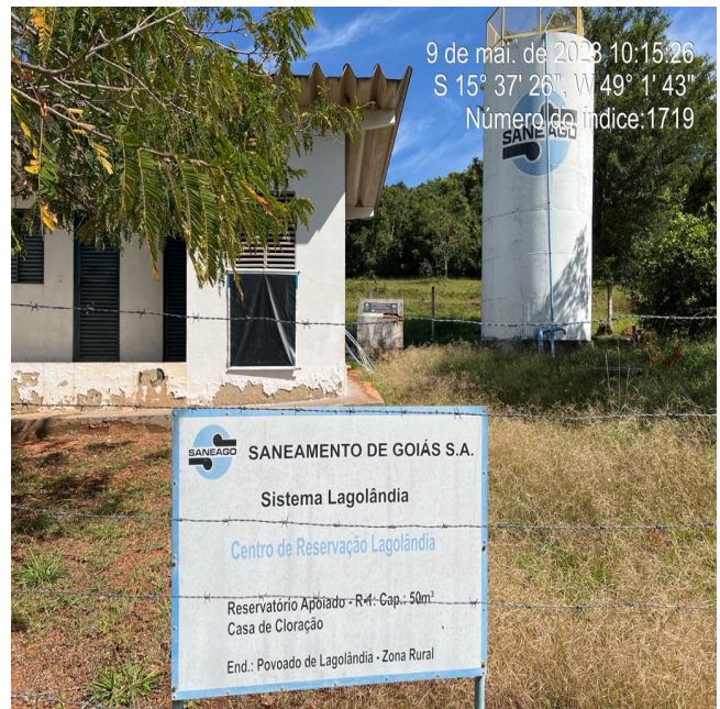
Foto 2 - Pintura desgastada e perda de revestimento da parte externa da casa de cloração.
