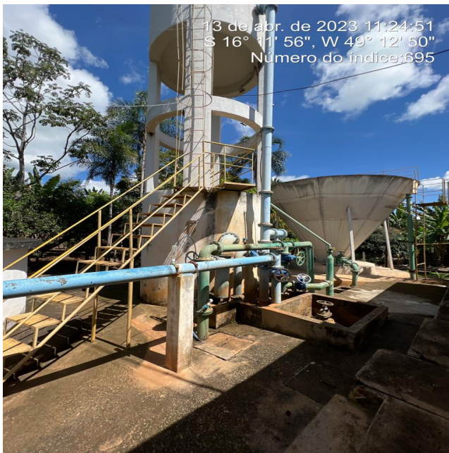
Foto 1 - ETA/Filtro Russo com pintura desgastada.
