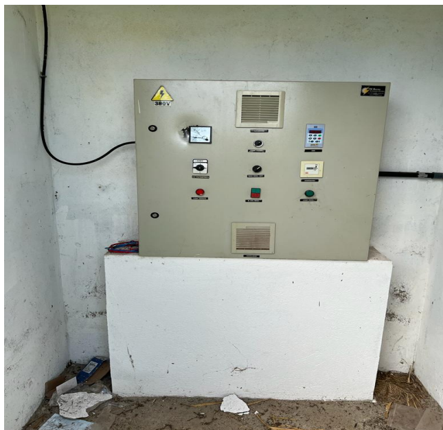
Fotos 11 - Poço com área de risco sem aviso de advertência.
