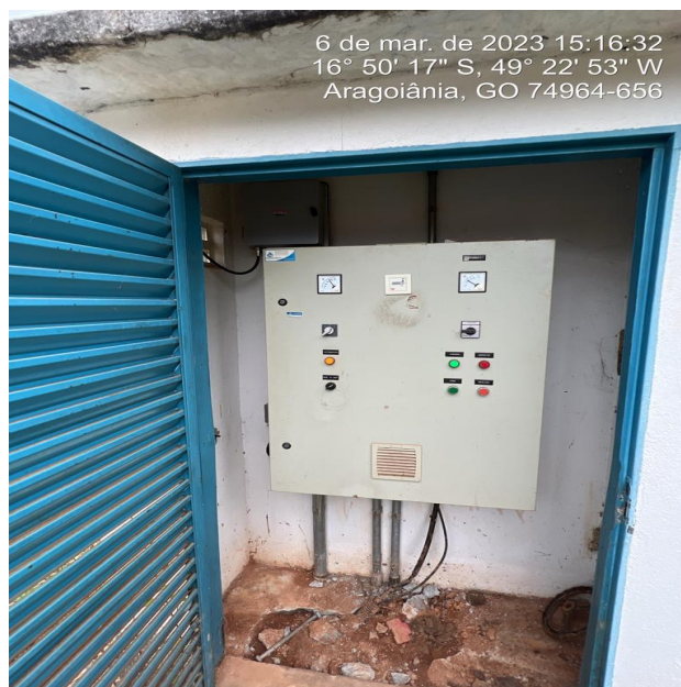
Foto 14 - Poço com área de risco sem aviso de advertência.
