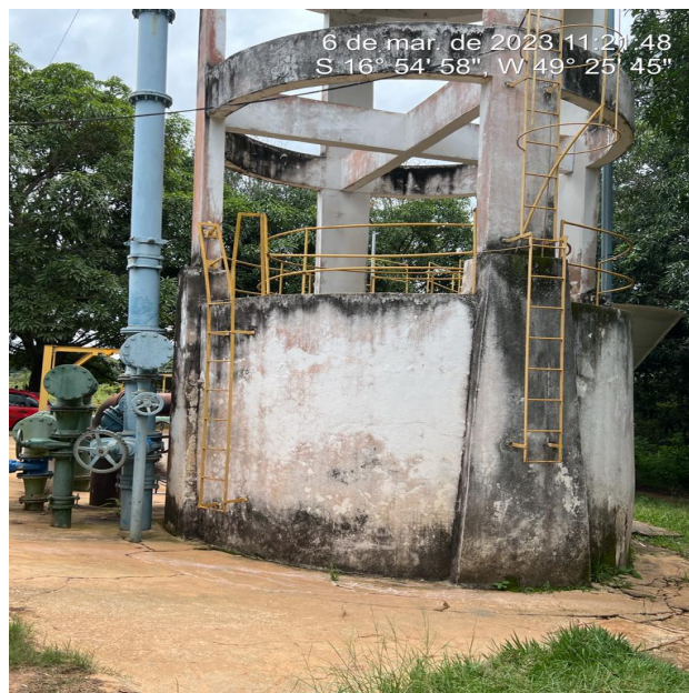
Foto 4 - Ausência de guarda-corpos na escada dos filtros da ETA.
