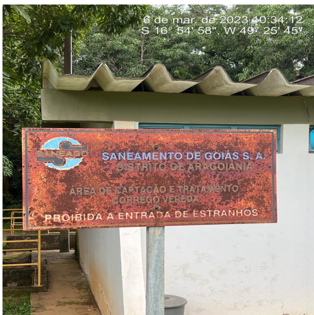
Foto 1 - Placa de identificação da ETA desgastada.
