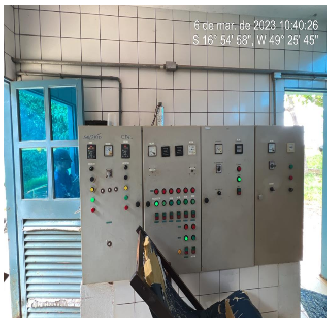
Foto 7 - Quadro de comando da EEAT sem aviso de advertência.
