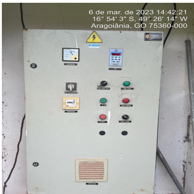
Foto 13- Poço com área de risco sem aviso de advertência.
