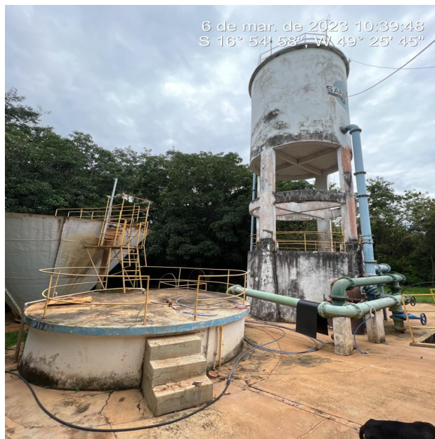
Foto 6 - Edificações da ETA com pintura desgastada.
