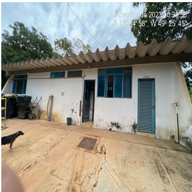
Foto 5 -Edificações da ETA com pintura desgastada.
