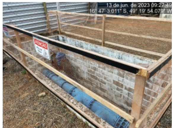
Foto 10 - Elevatória CR Parque Sul
