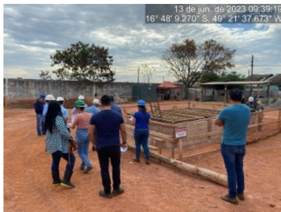
Foto 11 - Elevatória CR Alto Paraíso
