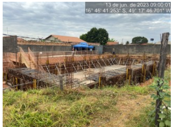
Foto 8 - Elevatória CR Morada dos Pássaros
