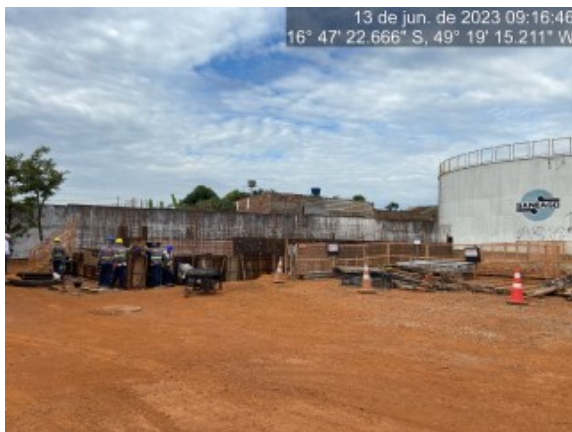
Foto 9 - Elevatória CR Buriti Sereno
