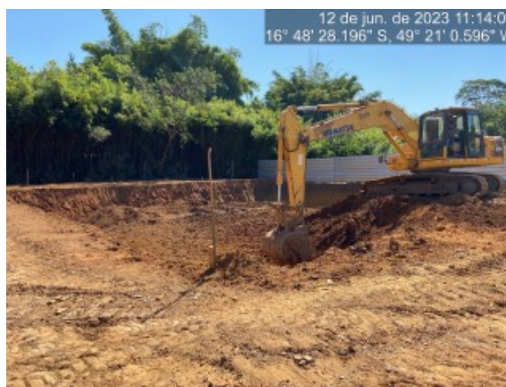
Foto 14 - Elevatória de Esgoto Dourado
