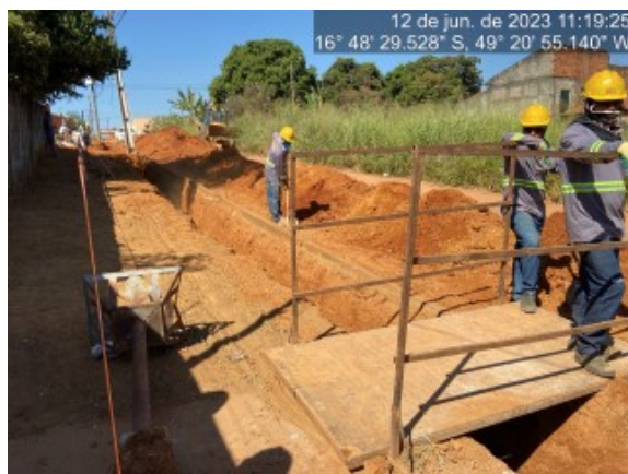
Foto 15 - Rede coletora de esgoto Jd. Alto Paraíso
