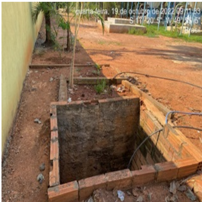
Foto 9 - ETA/Recomenda-se instalação de grade ou tampa de proteção das caixas de passagem.
