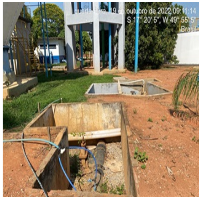
Foto 8 - ETA/Recomenda-se instalação de grade ou tampa de proteção das caixas de passagem.
