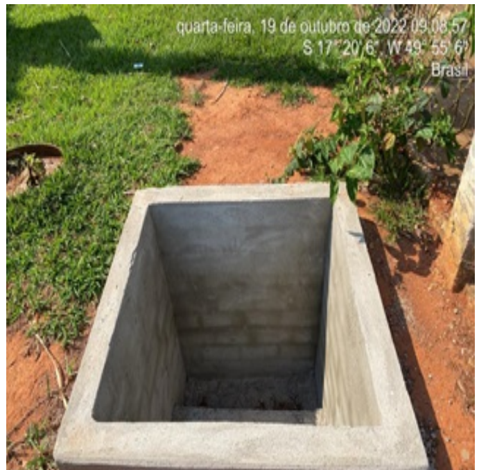
Foto 10 - ETA/Recomenda-se instalação de grade ou tampa de proteção das caixas de passagem.
