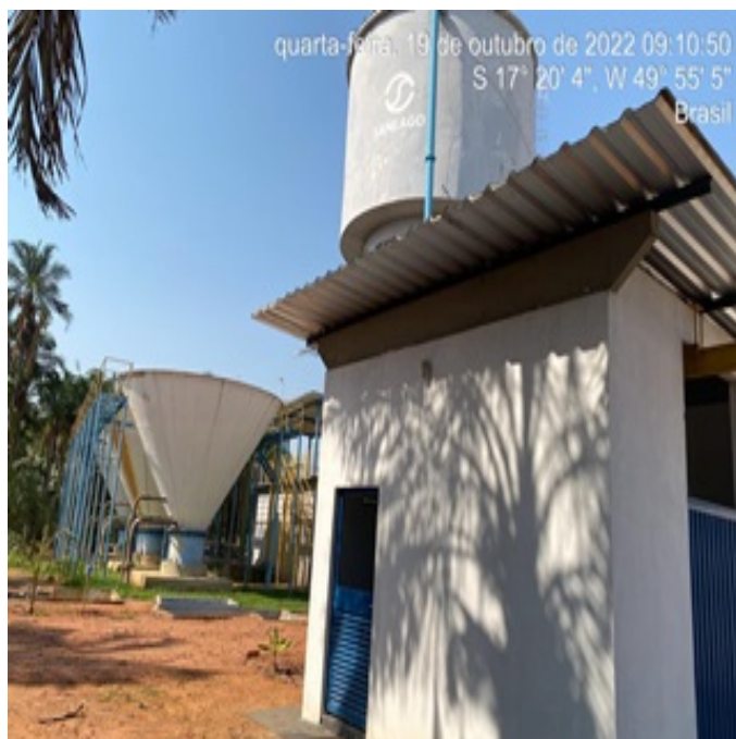
Foto 4 - ETA com pintura recuperada das unidades do SAA.
