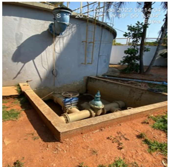
Foto 6 - ETA/RSE com vazamento do registro corrigido.
