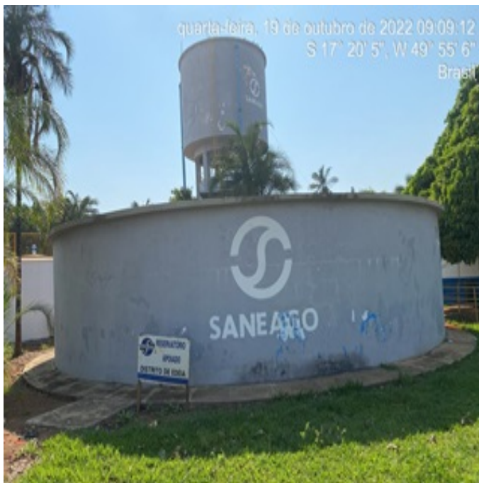
Foto 5 - ETA/RSE com pintura recuperada.
