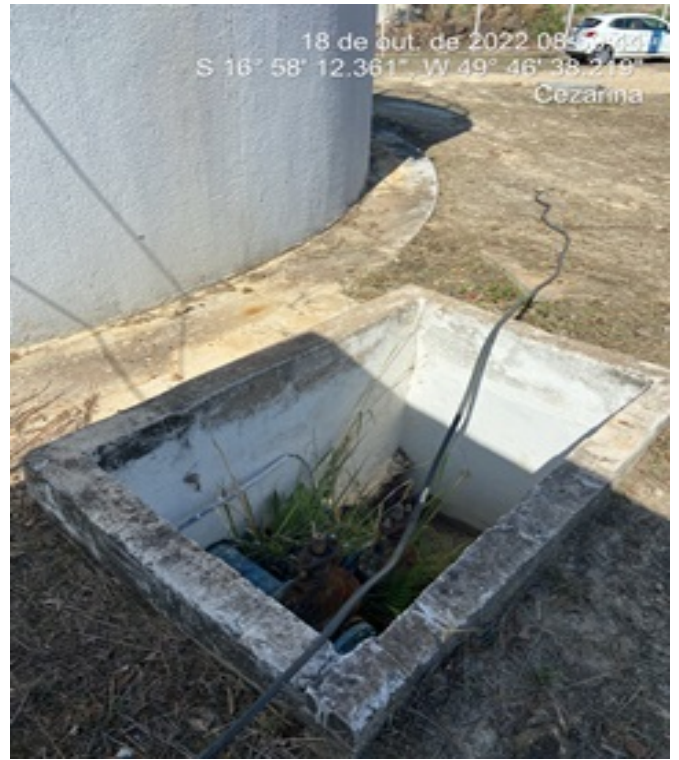
Foto 4 - C.R. recomenda-se instalação de tampa ou grade de proteção nas caixas de passagem.
