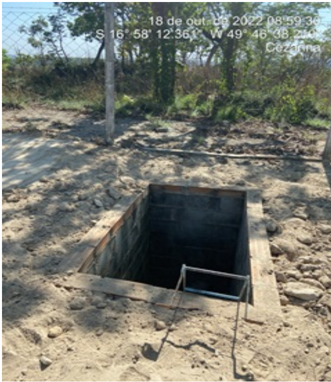
Foto 3 - C.R. recomenda-se instalação de tampa ou grade de proteção nas caixas de passagem.
