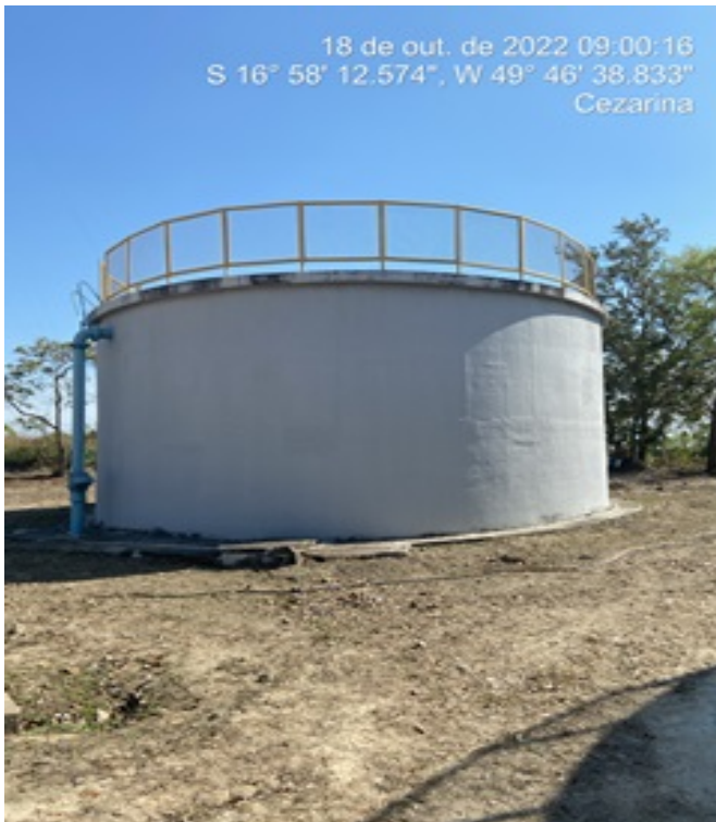
Foto 5 - C.R. RAP RI com pintura recuperada.
