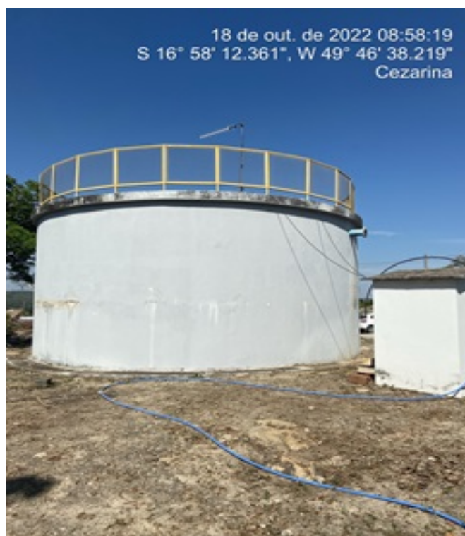
Foto 2 - C.R. RAP RI com pintura recuperada.
