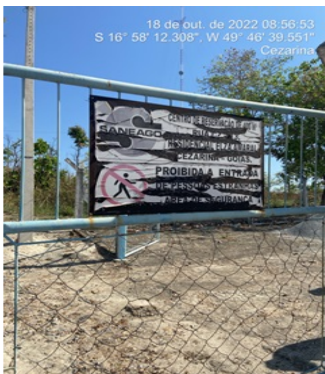
Foto 1 - Placa do C.R. com necessidade de recuperação.
