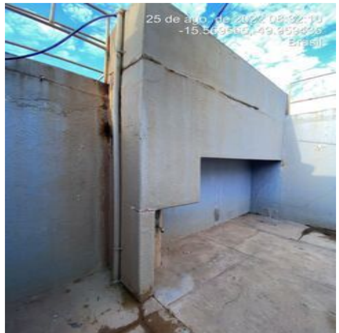
Foto 10 - Parede externa dos decantadores com presença de infiltrações.
