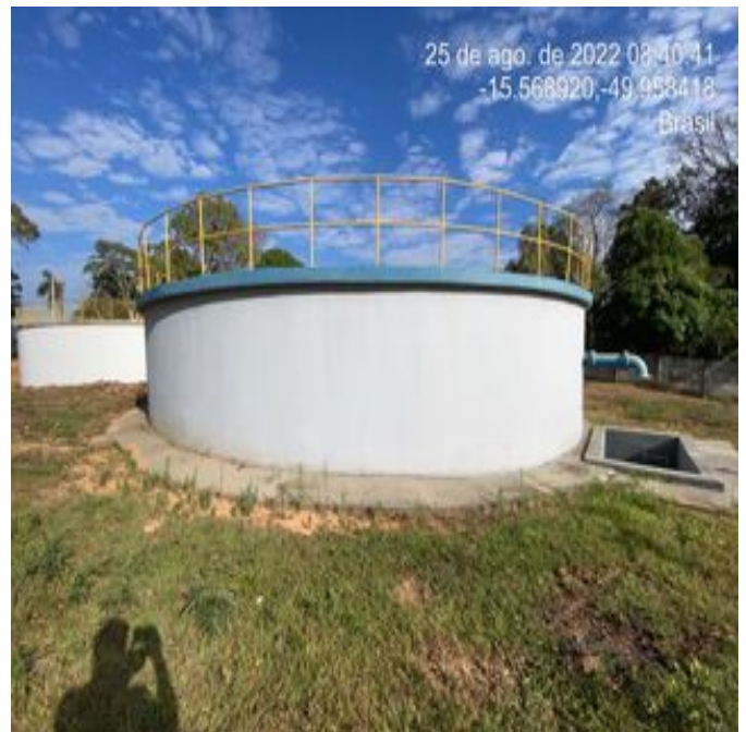
Foto 6 - Reservatório Semi-enterrado 2 com ausência de perda de revestimento.
