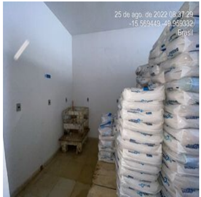
Foto 2 - Sala de estocagem de produtos químicos com ausência de perda de revestimento.
