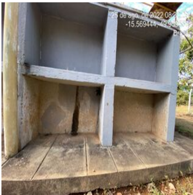
Foto 7 - Parede externa dos decantadores com presença de infiltrações.
