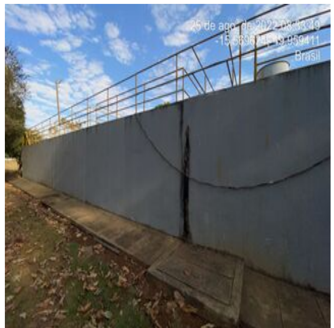
Foto 8 - Parede externa dos decantadores com presença de infiltrações.
