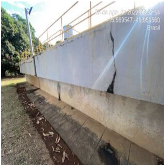
Foto 9 - Parede externa dos decantadores com presença de infiltrações.
