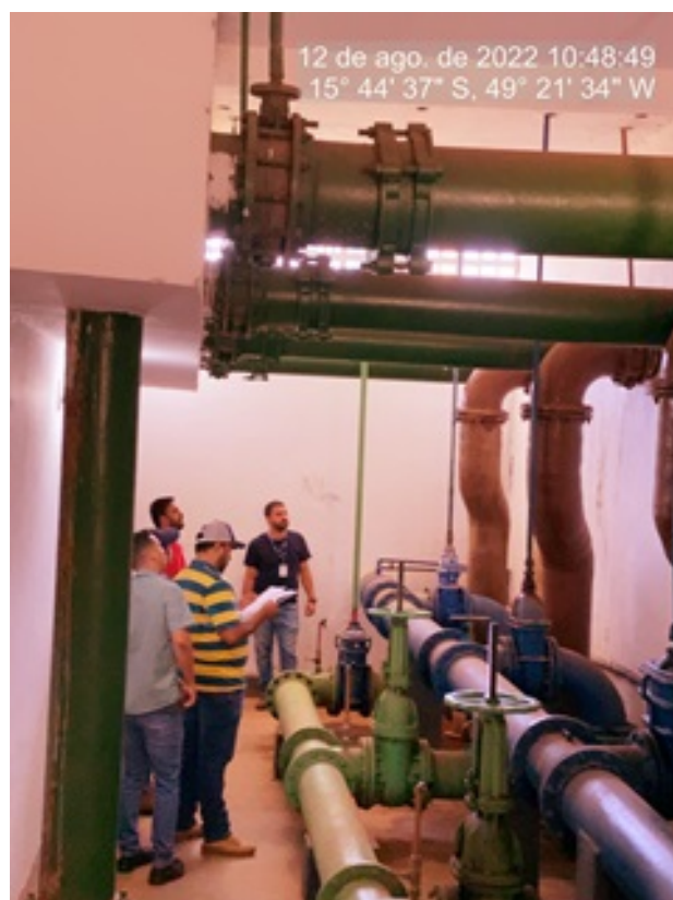
Foto 4 - Galeria dos filtros com vazamentos corrigidos.
