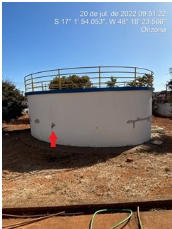
Foto 2 - RAP do Distrito com infiltração, detalhe central.
