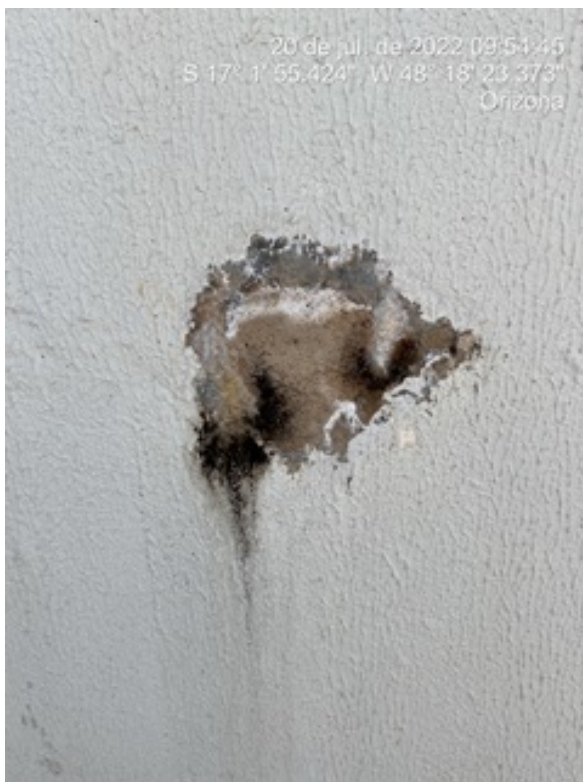
Foto 1 - RAP do Distrito com nova infiltração.
