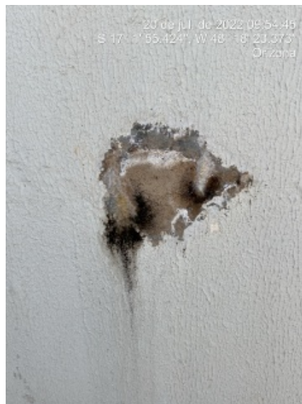
Foto 9 - RAP do Distrito com nova infiltração.
