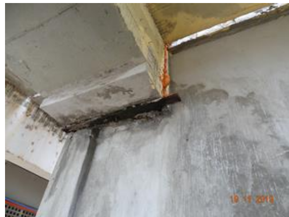
Foto 2 - Vazamento na calha parshall recuperado.
