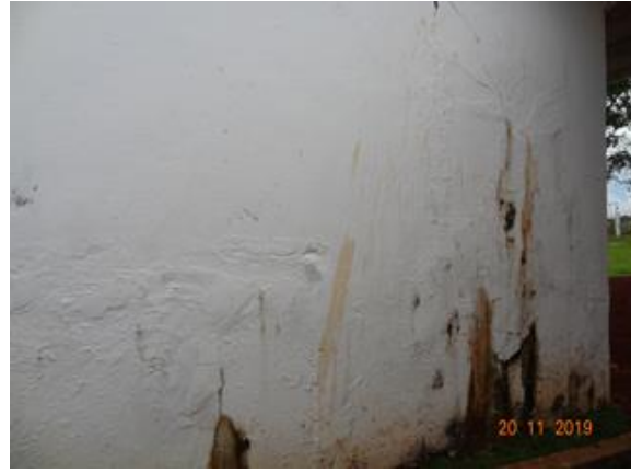
Foto 2 - Novas infiltrações na ETA
