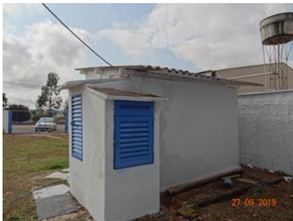
Foto 1 - Quadro de comando da EEAB com tampa.
