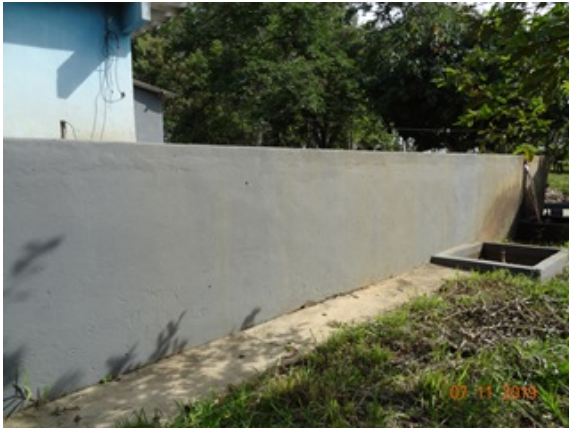
Foto 3 - Poço de sucção da EEAB/Captação com ausência de extravasamento (reparado).
