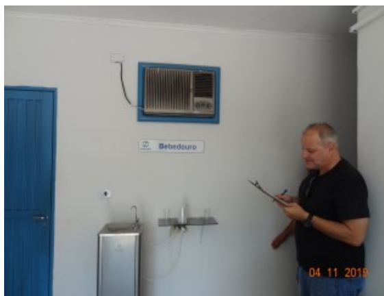
Foto 2 - Bebedouro instalado escritório comercial.
