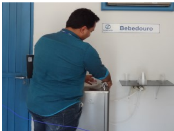
Foto 1 - Bebedouro instalado escritório comercial.
