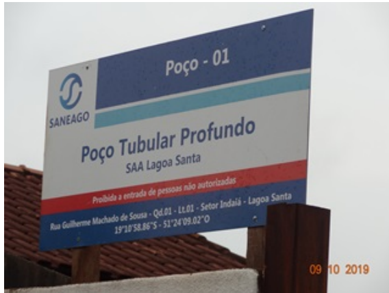
Foto 1 - Poço 01 com placa de identificação.
