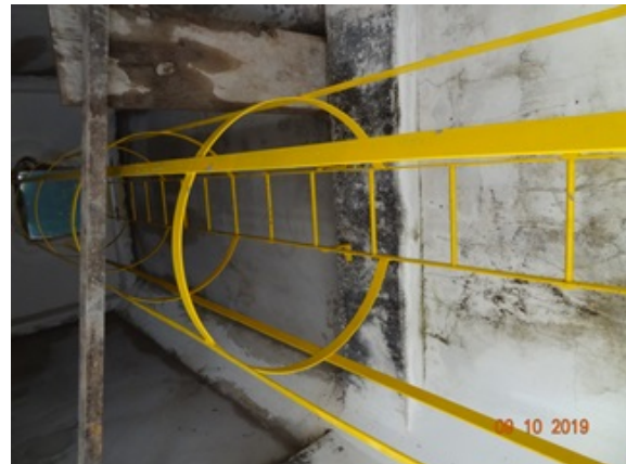
Foto 4 - REL da ETA com escada instalada.
