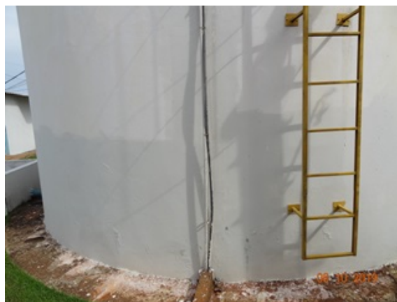
Foto 6 - RAP RII com infiltrações e eflorações corrigidas.
