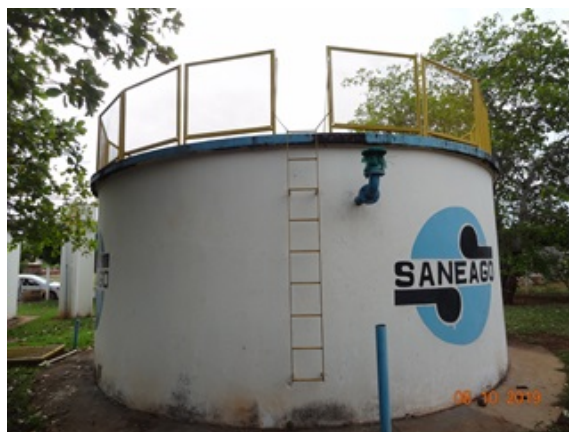
Foto 2 - RAP RI com escada de acesso instalada.
