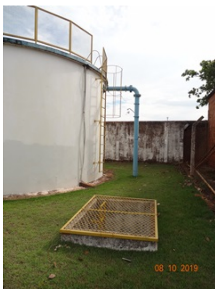
Foto 5 - RAP RII com tampas nas caixas de passagem.
