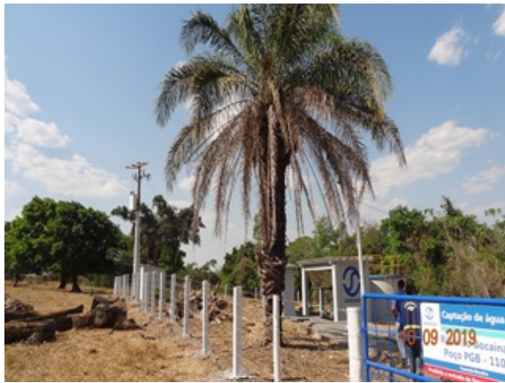
Foto 5 - Captação e poço com identificação.
