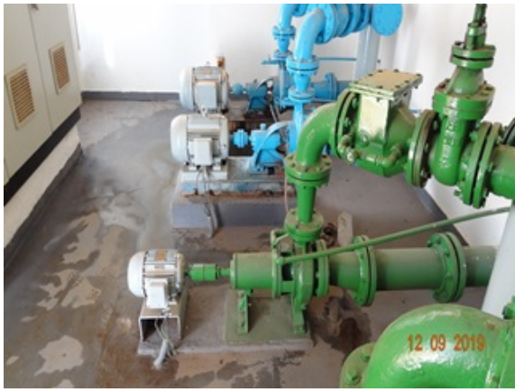
Foto 1 - Conjunto moto-bomba com vazamentos corrigidos.
