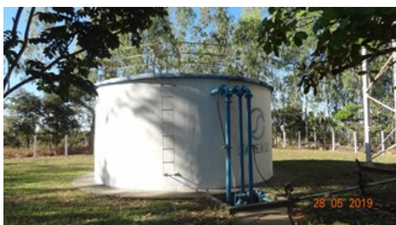
Foto 7 - RAP da ETA com pintura recuperada.
