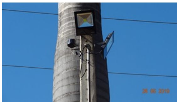
Foto 2 - EEE I com sistema de iluminação recuperado.
