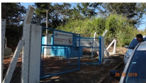
Foto 3 - EEE II com pintura recuperada.
