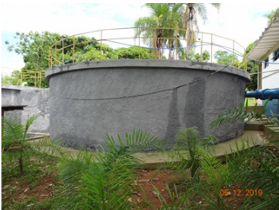
Foto 9 - Reservatório RSE/ETA, com constatações corrigidas.
