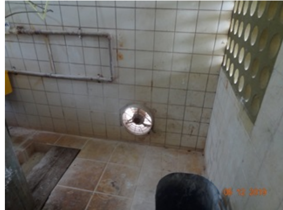
Foto 2 - ETA, sala do clorador com espaço desobstruído.
