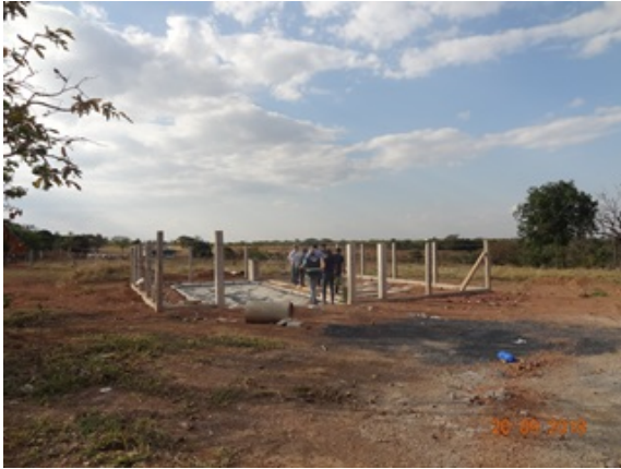
Foto 7 - Obra do SES inacabada
