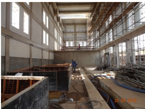
Foto 3 - Visão interna da EEAB
