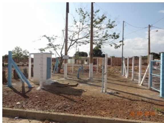
Foto 4 - Sistema de poços
