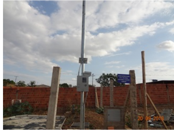
Foto 8 - Obra do SES inacabada
