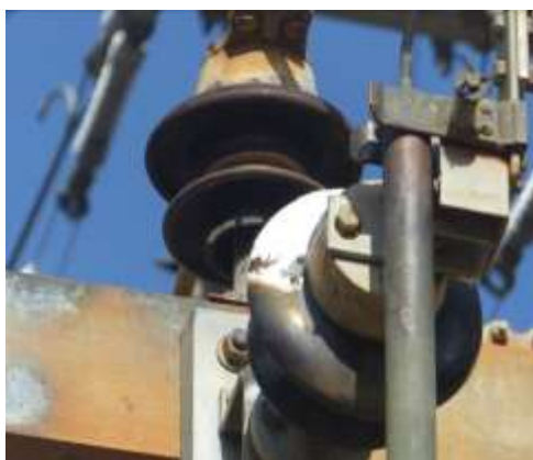
Foto 44.1 – Deterioração do isolador - ATL-S
