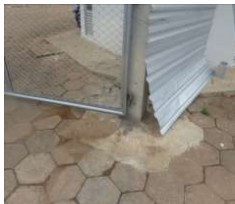
Foto 43.4 - Inexistência de aterramento em cerca/portão – FER-S
