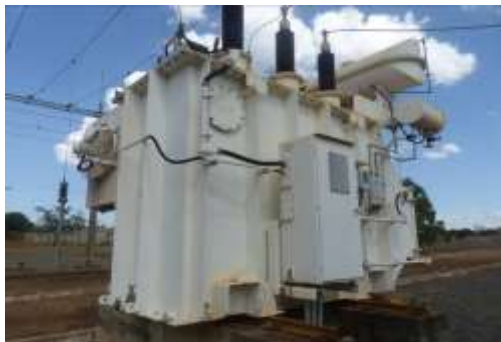
Foto 32.1 - Inexistência de bacia de contenção – ALE-S
