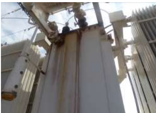
Foto 34.14 - merejamento – Trafo TB 279
