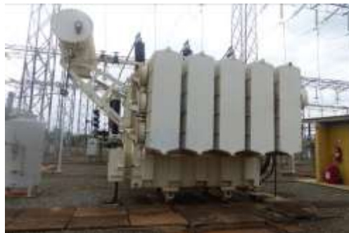
Foto 32.8 - Inexistência de bacia de contenção – FER-S
