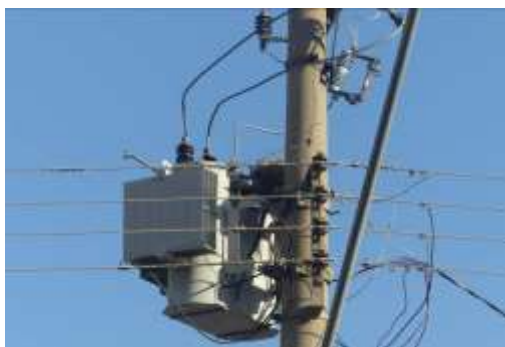
Foto 21.1 – Sujeira no transformador – GN11-1126
