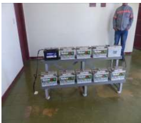
Foto 40.7 - Inexistência de exaustor – MRO-S
