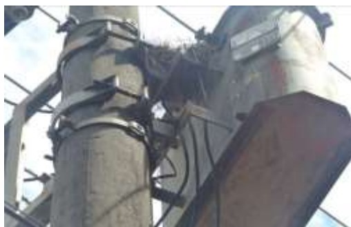
Foto 21.3 – Sujeira no transformador – GN11-1750
