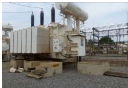
Foto 32.6 - Inexistência de bacia de contenção – INP-S
