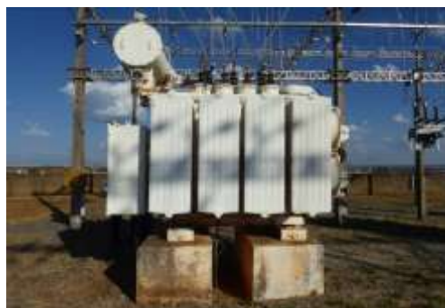
Foto 32.10 - Inexistência de bacia de contenção – VAL-D
