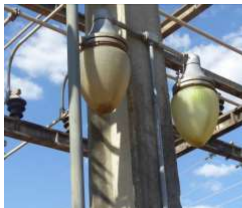
Foto 39.4 - Ausência/deficiência de iluminação – MRO-S
