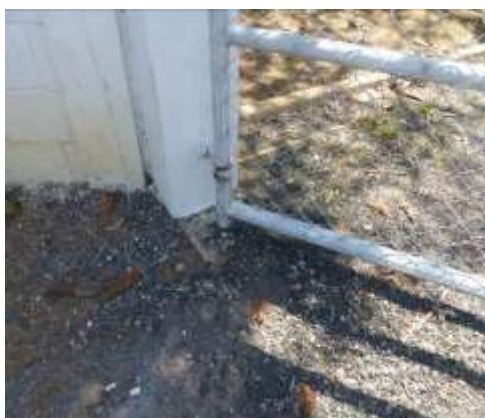
Foto 43.3 - Inexistência de aterramento em portão – CAT-S
