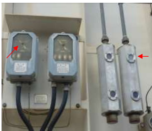
Foto 37.1 – Visor de temperatura e sílica gel ALE-S -Trafo 3
