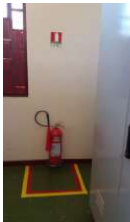
Figura 19 – SE Campinas – Sala de Comando
