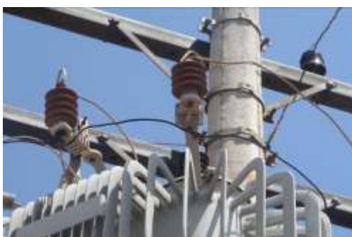
Foto 22.4 – para-raios danificado – JT11-294255
