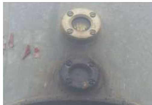
Foto 34.12 vazamento e/ou merejamento – TP 16
