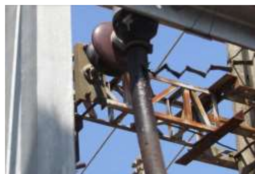
Foto 34.16 - merejamento – mufla 13.8 kV
