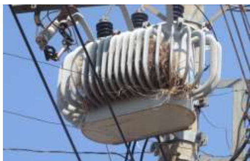
Foto 21.5 – Sujeira nos radiadores do transformador JT11-341173
