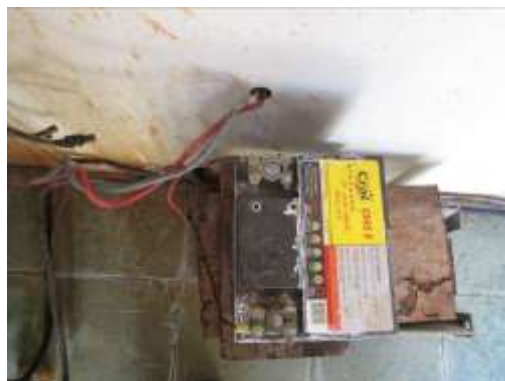
Foto 40.9 – Bateria deteriorada – RVE-S
