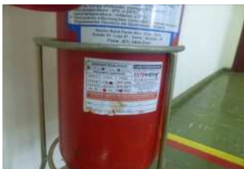
Foto 31.1 – Extintor com data de validade vencida – CAM-S
