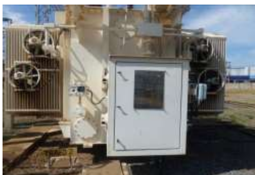
Foto 32.3 - Inexistência de bacia de contenção – CAM-S
