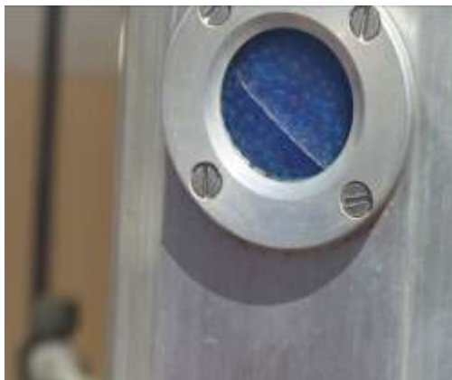
Foto 37.3 - Visor danificado – CAM-S -Trafo 2
