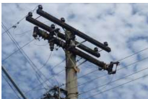
Foto 22.3 – para-raios danificado – GN11-2211
