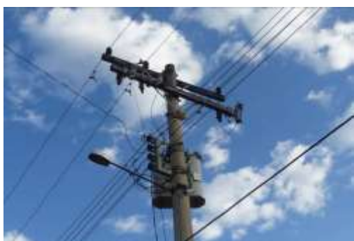
Foto 22.7 – para-raios danificado – LZ11-29353
