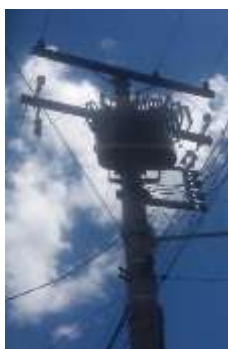
Figura 06 - Radiadores do transformador KR11-170149
