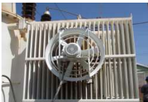
Foto 35.1 - Ventilação forçada inoperante – JAT -Trafo 2
