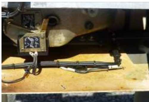
Foto 34.6 - vazamento e/ou merejamento – DAI-S –SEC 670
