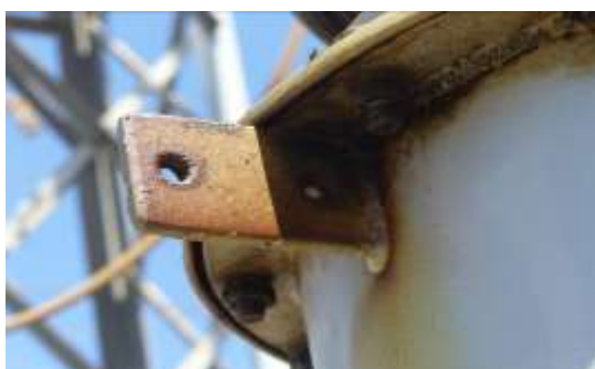
Foto 34.4 - vazamento e/ou merejamento – TC-115
