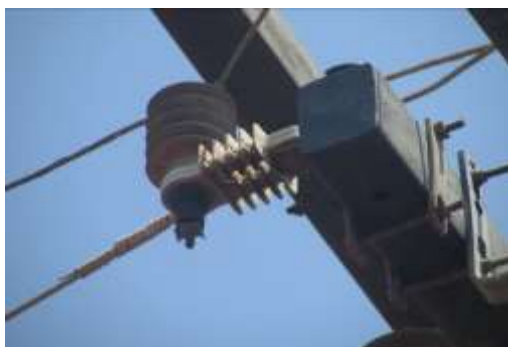
Foto 22.5 – para-raios danificado – JT11-184025
