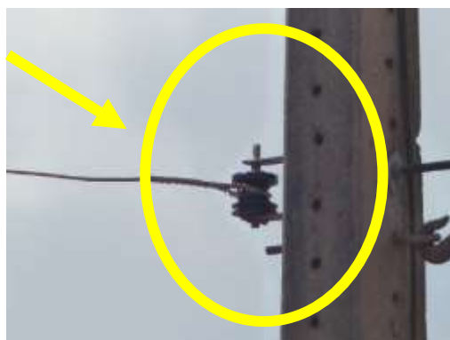
Figura 91 – SE Alexania (foto 48.4 RF) Cabo neutro apenas ancorado sem conexão a terra .
