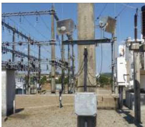
Foto 39.1 - Ausência/deficiência de iluminação – CPG-S
