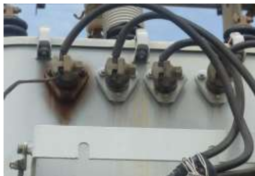
Foto 34.11 - vazamento e/ou merejamento – Transformador Auxiliar
