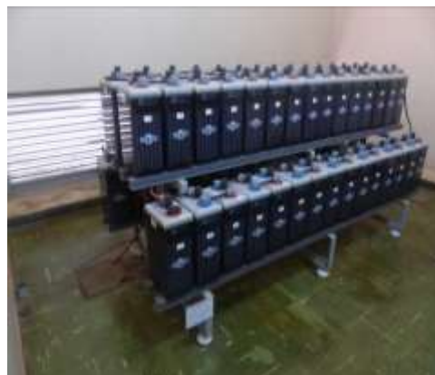
Foto 40.2 - Inexistência de exaustor – ATL-S
