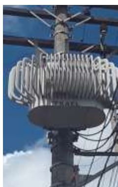
Figura 04 – Radiadores do transformador JT11-260349
