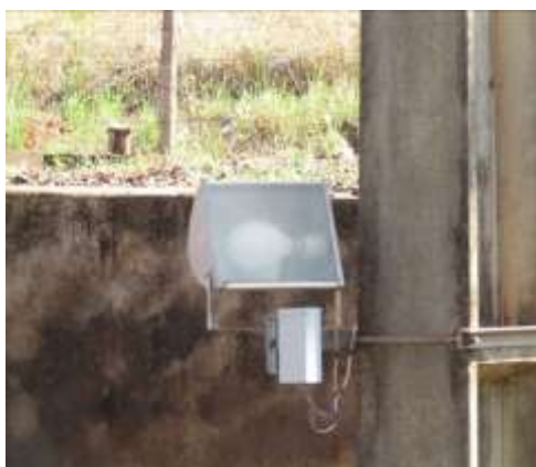
Foto 39.5 - Ausência/deficiência de iluminação – RVE-S
