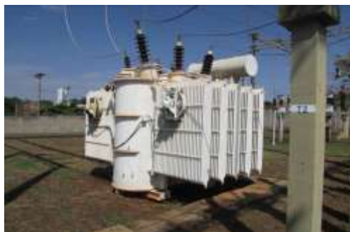
Foto 32.7 - Inexistência de bacia de contenção – JAT-S
