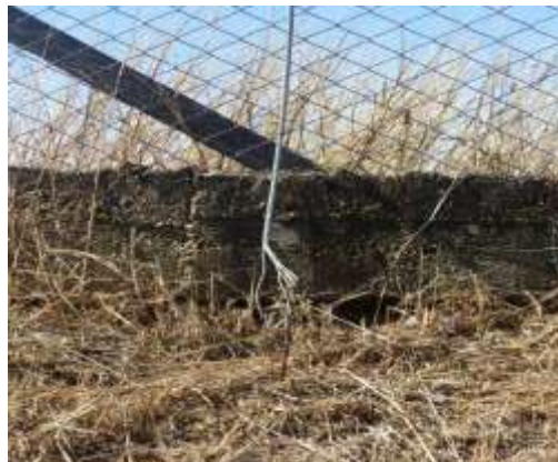
Foto 43.2 - Aterramento do alambrado danificado – CPG-S
