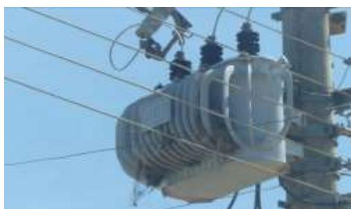
Foto 21.7 – Sujeira nos radiadores do transformador KR11-200491
