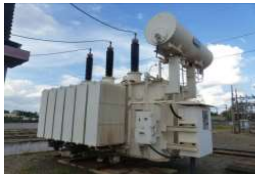
Foto 32.2 - Inexistência de bacia de contenção – ATL-S
