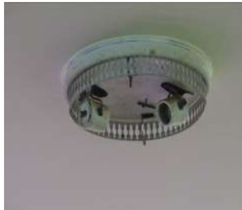
Foto 39.10 - Ausência/deficiência de iluminação de emergência – CAT-S
