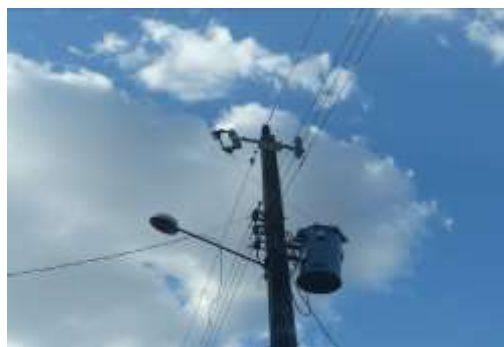
Foto 22.6 – para-raios danificado – LZ11-92827
