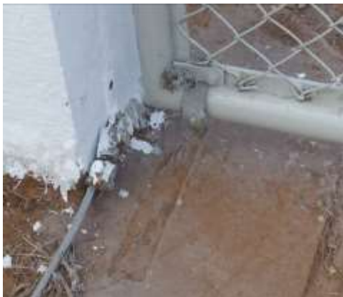
Foto 43.1 - Inexistência de aterramento em cerca/portão – ALE-S
