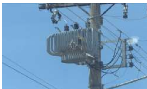
Foto 21.8 – Sujeira nos radiadores do transformador KR11-170149
