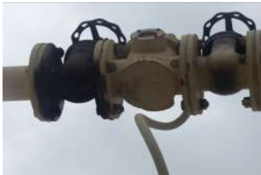
Foto 34.9 - vazamento e/ou merejamento – FER –T1
