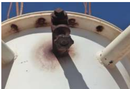
Foto 34.5 - vazamento e/ou merejamento –CRS-D –Trafo 2
