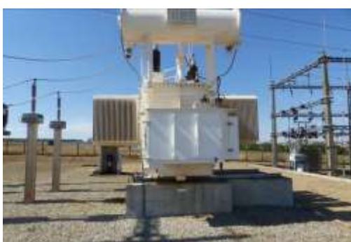
Foto 32.4 - Inexistência de bacia de contenção – CPG-S
