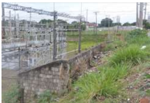
Foto 30.5 - SE Ferroviário (facilidade de acesso muro)
