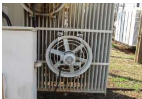
Foto 35.2 - Ventilação forçada inoperante – JAT -Trafo 2
