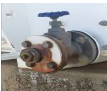
Foto 34.3 - vazamento e/ou merejamento – CGP-S –Trafo 2
