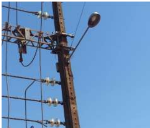
Foto 39.3 - Ausência/deficiência de iluminação – CRS-D
