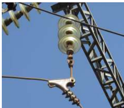
Foto 44.6 – Cadeia de isoladores incompleta - JAT-S
