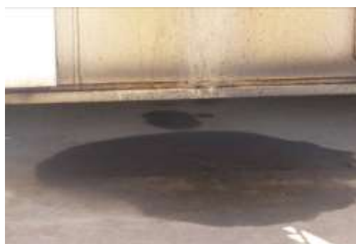
Foto 34.2 - vazamento e/ou merejamento – CAM-S -Trafo 3
