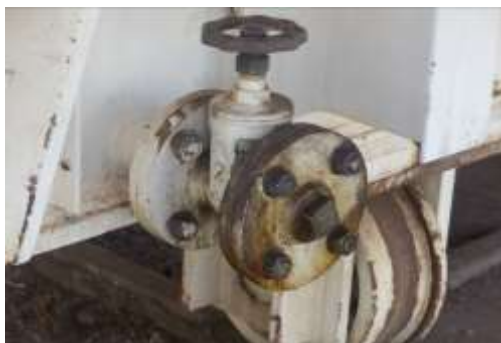
Foto 34.1 - vazamento e/ou merejamento – CAM-S -Trafo 2
