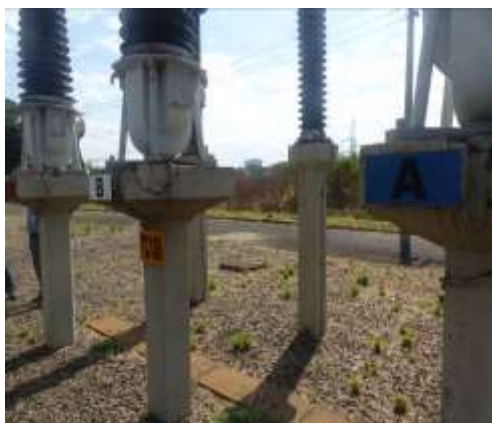
Foto 41.3 – Estrutura danificada TC-106 – CAM-S
