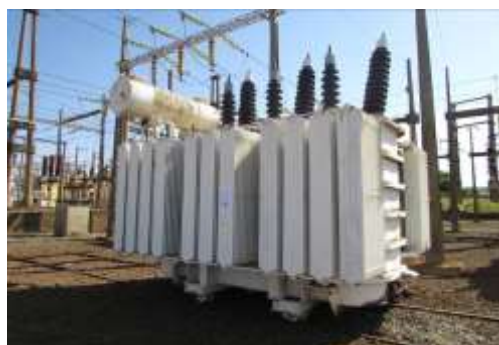
Foto 32.9 - Inexistência de bacia de contenção – RVE-S
