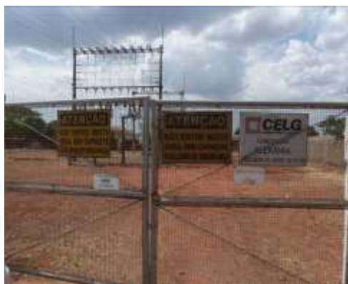
Foto 48.3 – Conexão do neutro do ramal externo – SE Alexânia
