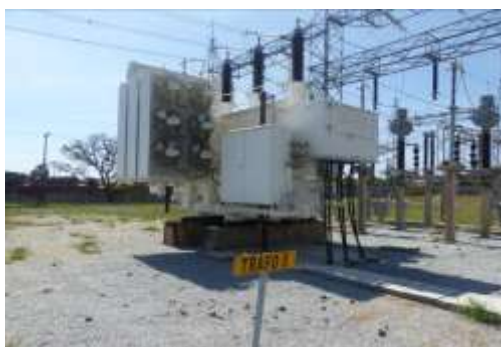
Foto 32.5 - Inexistência de bacia de contenção – CAT-S
