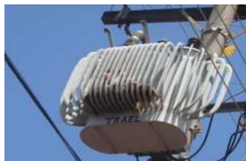
Foto 21.6 – Sujeira nos radiadores do transformador JT11-260349
