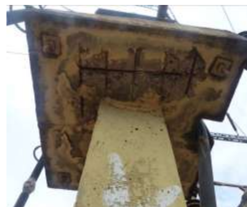
Foto 41.8 – Base TP ferragem exposta – TRI-S
