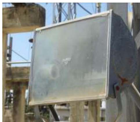
Foto 39.2 - Ausência/deficiência de iluminação – CAT-S
