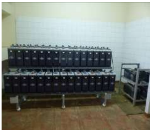
Foto 40.3 - Inexistência de exaustor – CAM-S
