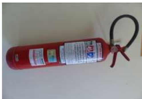
Foto 31.2 – Extintor com data de validade vencida – MRO-S
