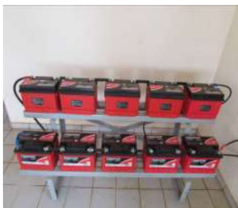
Foto 40.8 – Inexistência de exaustor – QUI-S
