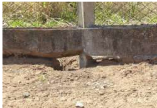
Foto 30.4 - SE DAIA (facilidade de acesso cerca)
