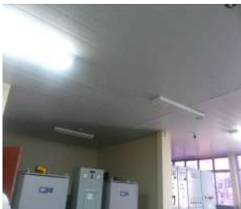
Foto 39.7 - Ausência/deficiência de iluminação – CAM-S
