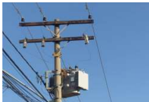
Foto 21.2 – Sujeira no transformador GN11-2110
