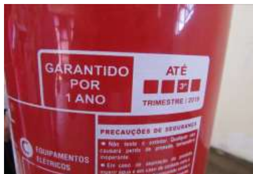
Foto 31.4 – Extintor sem selo do IMETRO – QUI-S
