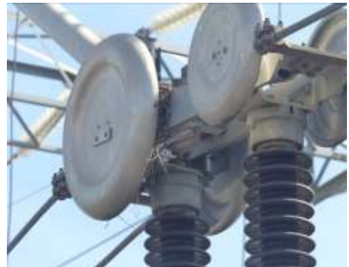
Foto 42.4 – sujeira- chave seccionadora – CAT-S
