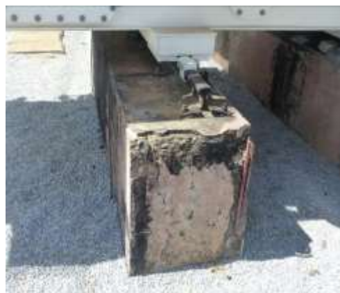
Foto 41.4 – Estrutura danificada –T5 – CAT-S
