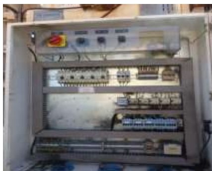
Foto 35.3 - Ventilação forçada inoperante/avariada – CRS-D -Trafo 3
