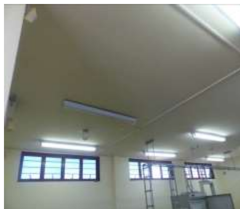
Foto 39.8 - Ausência/deficiência de iluminação – CPG-S
