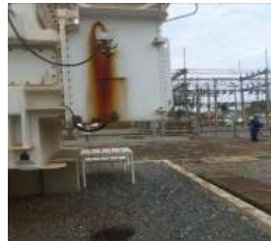
Foto 34.10 - vazamento e/ou merejamento – Trafo 2
