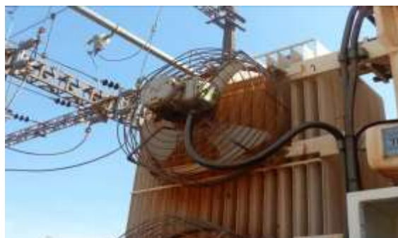
Foto 35.4 - Ventilação forçada inoperante/avariada – CRS-DS -Trafo 1
