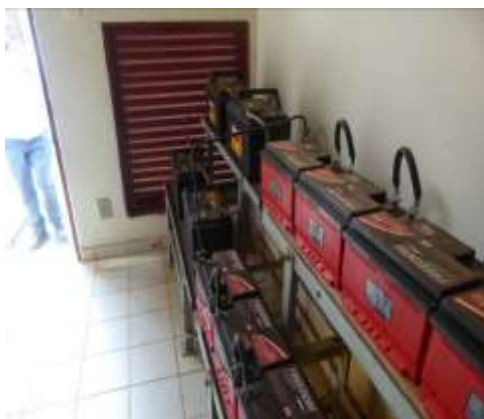
Foto 40.1 - Inexistência de exaustor – ALE-S
