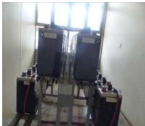
Foto 40.4 – Inexistência de exaustor – FER-S
