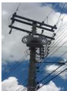
Figura 05 – Radiadores do transformador KR11-200491
