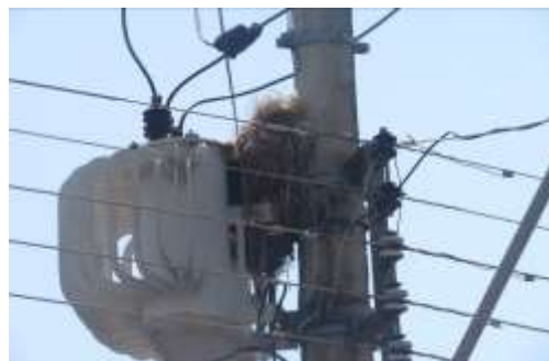
Foto 21.4 – Sujeira no transformador – JT11-036268
