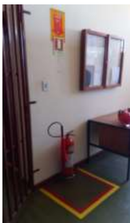
Figura 20 – SE Campinas – Sala de Comando
