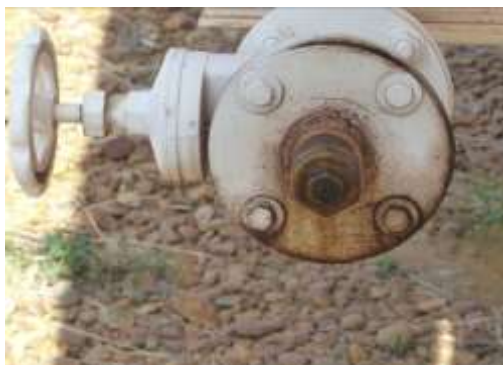
Foto 34.13 - gotejamento – Trafo TD 00036
