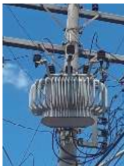
Figura 03 – Radiadores do transformador JT11-341173
