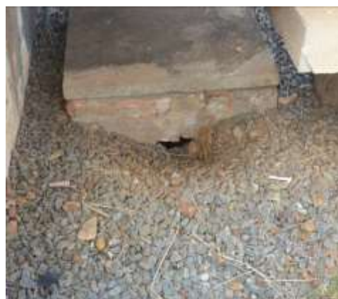
Foto 41.2 – Caixa de passagem danificada Trafo 1 – ALE-S
