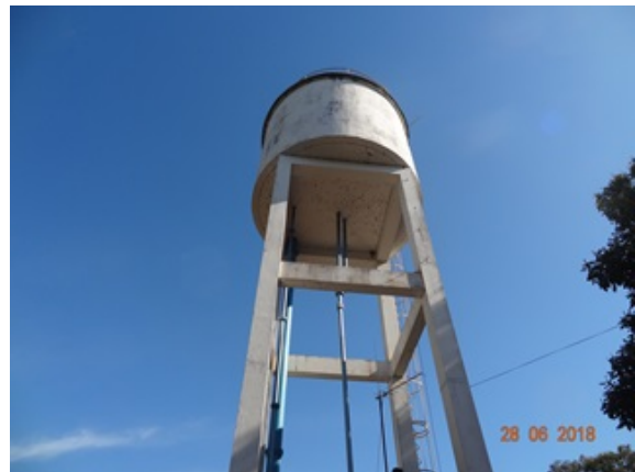
Foto 4 - REL da ETA com pintura desgastada.
