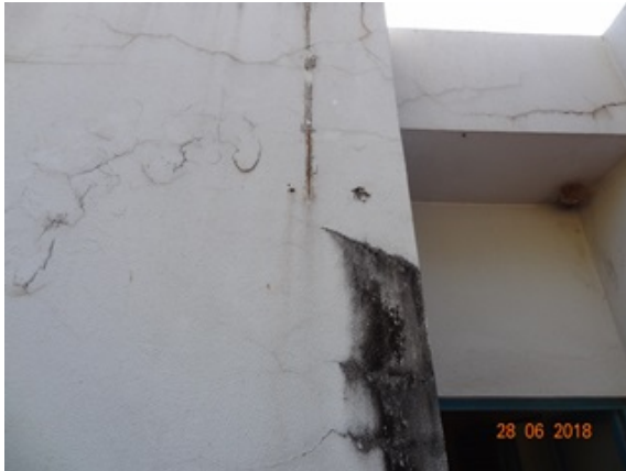
Foto 1 - Pintura desgastadas das edificações da ETA.
