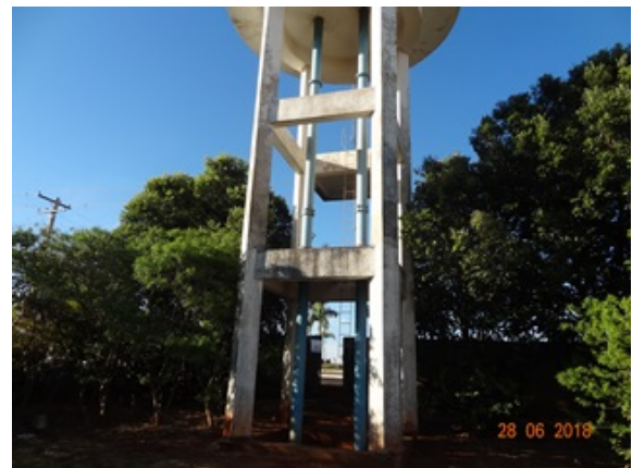
Foto 6 - REL Primavera sem guarda-corpos na escada.
