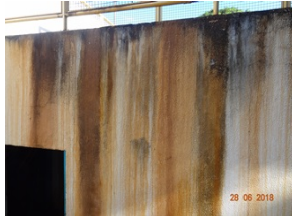
Foto 2 - Floculadores, floco-decantadores, decantação e filtração com rachaduras, infiltrações, eflorescências e mofo.
