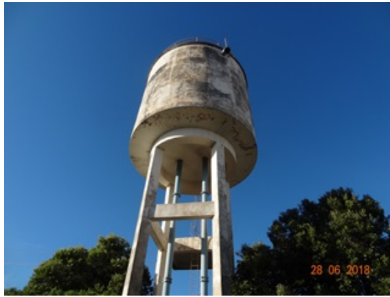
Foto 07 - REL Primavera com pintura desgastada.
