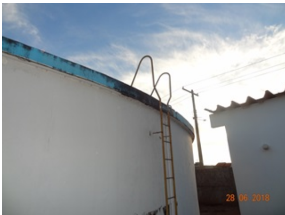
Foto 5 - Reservatório SE/C.R. distrito sem guarda-corpos na escada e topo.
