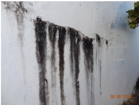
Foto 3 - Reservatório SE/C.R. distrito com presença de infiltrações, eflorescências e pintura desgastada.
