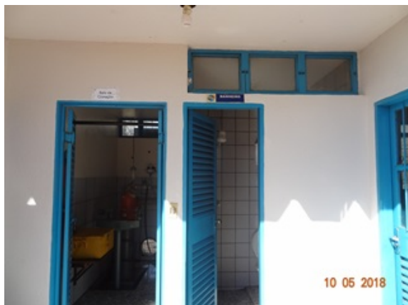
Foto 1 - Sala do clorador sem placa de aviso de advertência.
