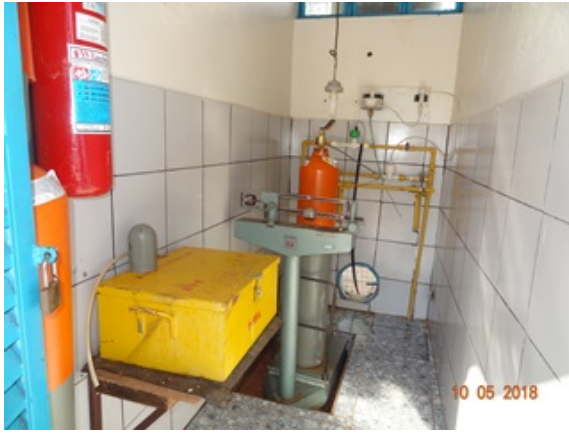
Foto 3 - Sala de cloração sem exaustor.
