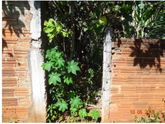
Foto 4 - Centro de Reservação: EEAT, REL e RAP área sem portão/e ou muro de proteção.
