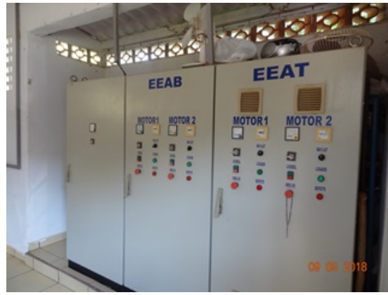
Foto 2 - Área de risco sem aviso de advertência EEAB e EEAT
