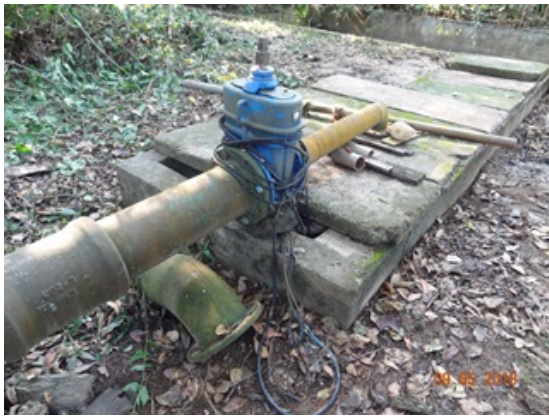
Foto 1 - Fios soltos próximo à bomba da EEAB
