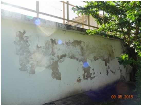
Foto 5 - Pintura desgastada e perda de revestimento nas edificações da ETA
