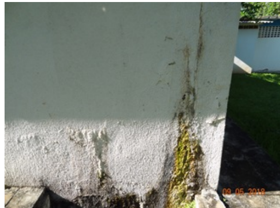
Foto 6 - Infiltrações nas edificações da ETA
