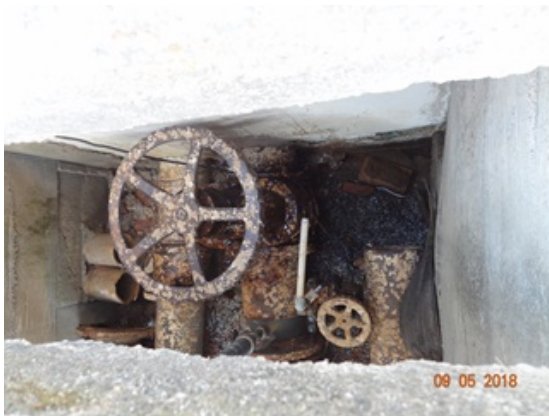
Foto 3 - Vazamento no registro de saída do REL
