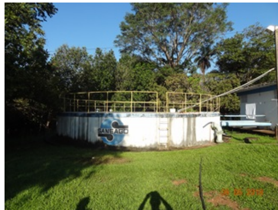
Foto 4 - Pintura desgastada no RSE
