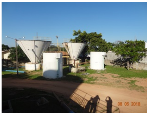
Foto 2 - Rachadura e vazamento na tubulação que chega ao filtro russo.
