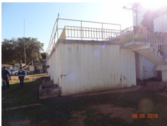
Foto 1 - ETA com pintura desgastada e eflorescências na parede dos flocculadores/decantadores
