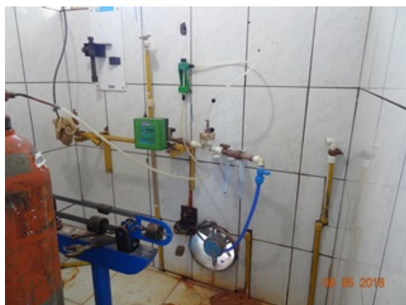
Foto 3 - Sala de dosagem do cloro gasoso sem exaustor e sem ventilação adequada.
