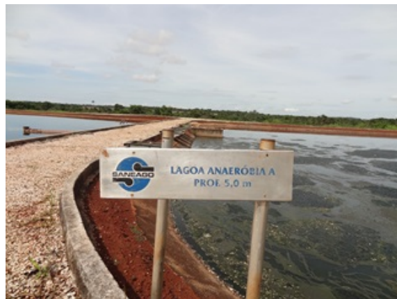
Foto 2 - ETE/Lagoa Anaeróbia (A) com taludes (bordas) desprotegidas e com início de erosão.
