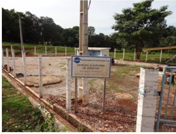
Foto 5 - EEE/Acreúna I com necessidade de infraestrutura para atendimento aos trabalhadores (servidores).
