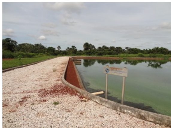
Foto 4 - ETE/ Lagoa de Maturação (2) com taludes (bordas) desprotegidas e com início de erosão.
