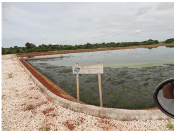
Foto 3 - ETE/Lagoa de Maturação (1) com taludes (bordas) desprotegidas e com início de erosão.
