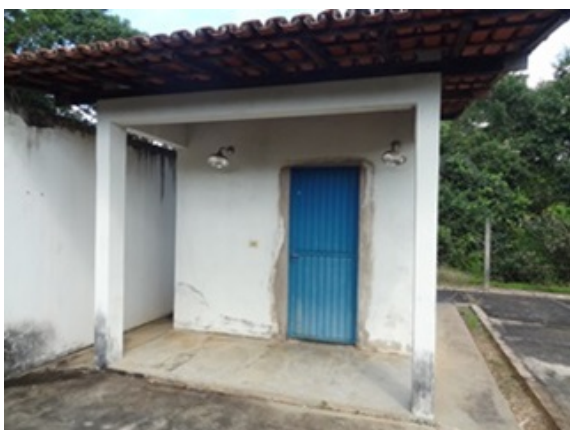
Foto 1 - Pintura desgastada das edificações da EEE II/Buqueirão.
