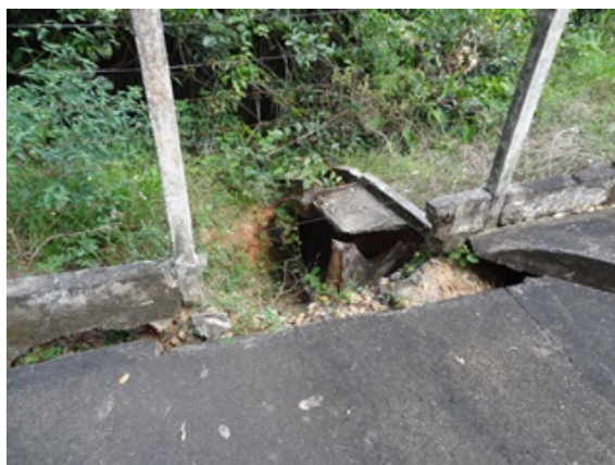
Foto 3 - Área da EEE II/Boqueirão danificada
