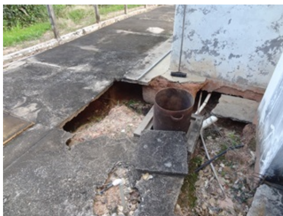
Foto 2 - Buracos na área da EEE II/Boqueirão
