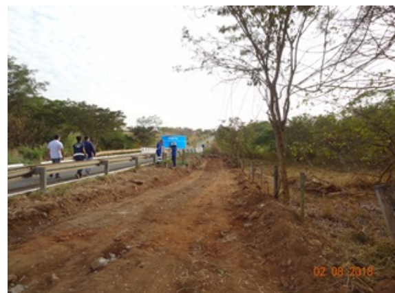
Foto 2 - Preparação da estrutura para receber caminhão Pipa próximo à captação do Ribeirão Santa Rosa.
