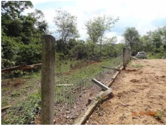
Foto 3 - Cerca danificada na área do Poço 02. Por motivo de manutenção da bomba do poço.
