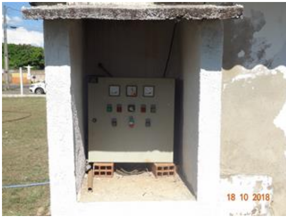
Foto 1 - Abrigo do quadro de comando da EEAB com ausência de tampa.
