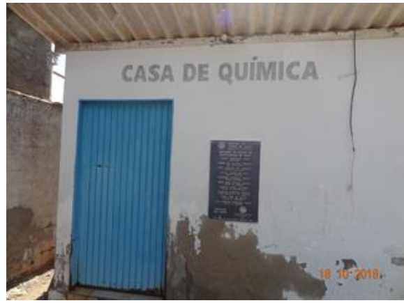
Foto 2 - Casa de química da área do RAP com perda de revestimento na parte externa.
