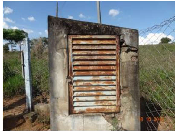
Foto 4 - Abrigo do quadro de comando do Poço 03 com ausência de pintura e perda de revestimento.
