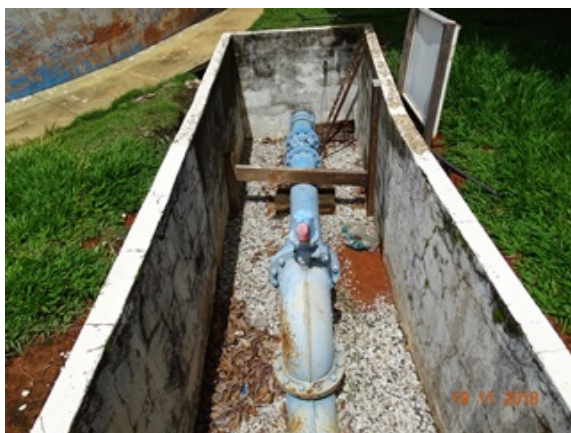
Foto 5 - Recomendado que se use uma grade de proteção, para evitar acidente de trabalho.
