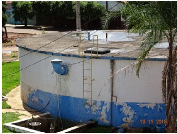
Foto 9 - Ausência de guarda-corpo no topo e escada.
