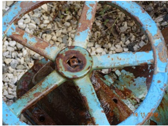
Foto 10 - Vazamento registro de saída.
