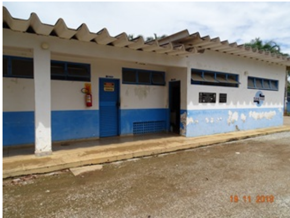
Foto 3 - Edificações com pintura desgastada
