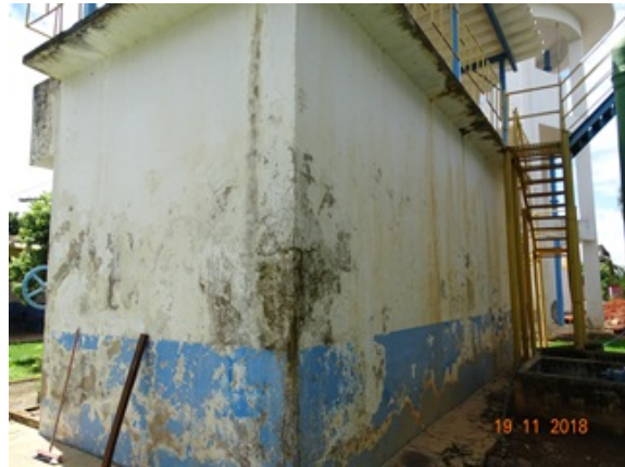
Foto 4 - Edificações com pintura desgastada.
