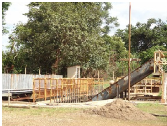
Foto 3 - ETE com guarda-corpos danificados no sistema preliminar de tratamento.
