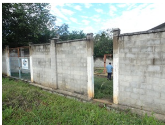
Foto 5 - EEE Vale dos Pássaros com edificações em mau estado de conservação.
