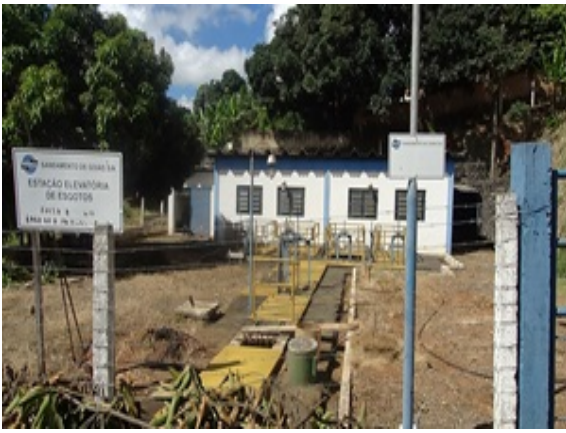
Foto 9 - EEE IV com placa de aviso de risco apagada.
