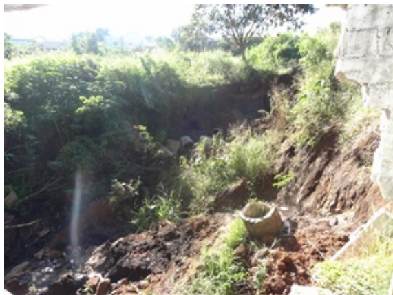
Foto 7 - EEE Vila Bela sendo danificada pela erosão localizada em sua lateral.
