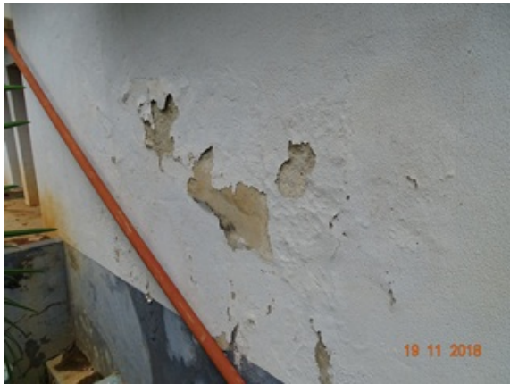
Foto 3 - Edificações da ETA com perda de revestimento e pintura desgastada.
