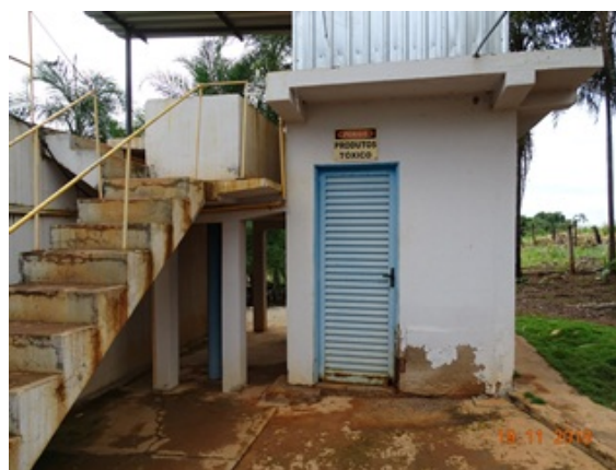
Foto 2 - Edificações da ETA com perda de revestimento e pintura desgastada.
