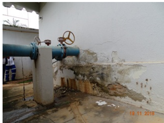
Foto 8 - Perda de revestimento e infiltrações.
