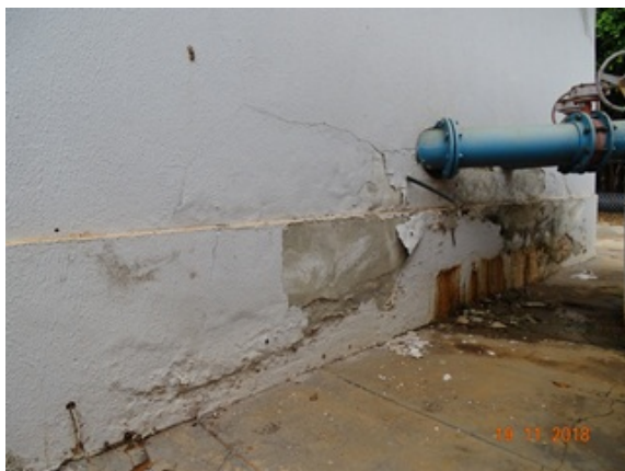
Foto 7 - Perda de revestimento e infiltrações.
