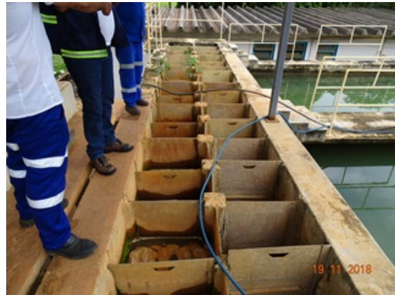
Foto 4 - Ausência de guarda-corpo nos floculadores.
