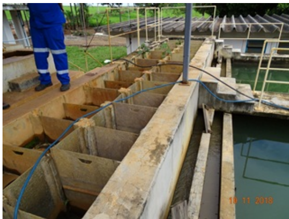
Foto 5 - Ausência de guarda-corpo nos floculadores.
