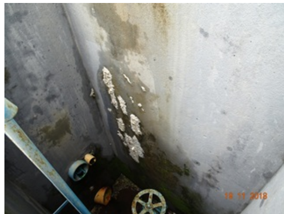
Foto 6 - Presença de infiltrações e eflorescências.
