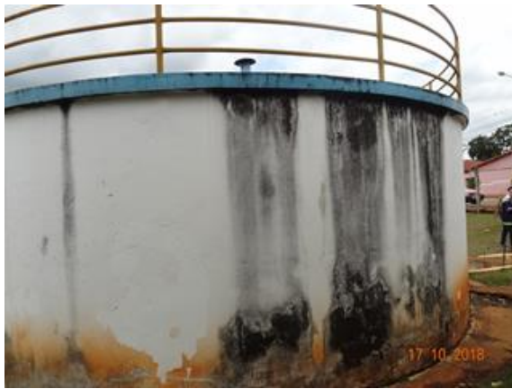
Foto 07 - RAP da ETA com Pintura desgastada.
