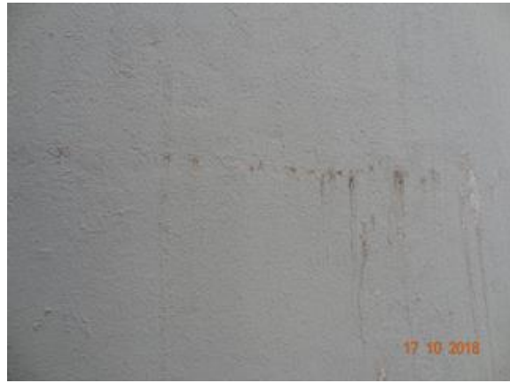
Foto 12 - RAP do Distrito com presença de infiltração.
