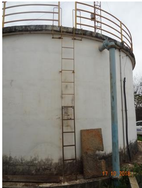
Foto 4 - RAP Santa Maria com ausência de guarda-corpo na escada de acesso ao reservatório.
