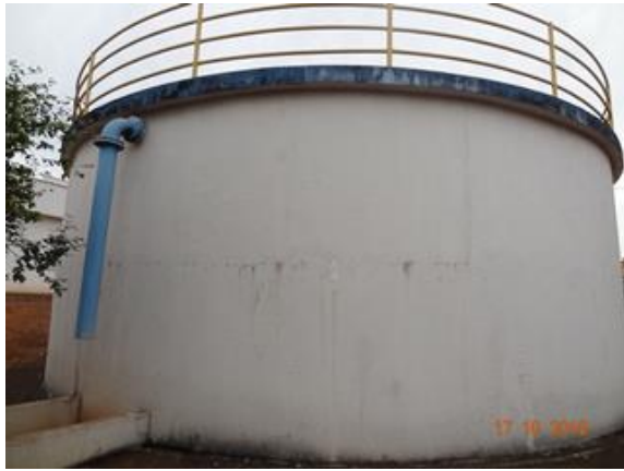
Foto 11 - RAP do Distrito com presença de infiltração.
