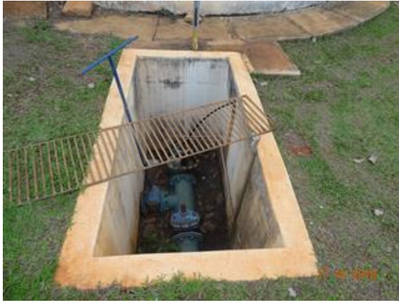
Foto 5 - RAP ETA com caixas de inspeção, passagem e/ou medição com tampas inadequadas.
