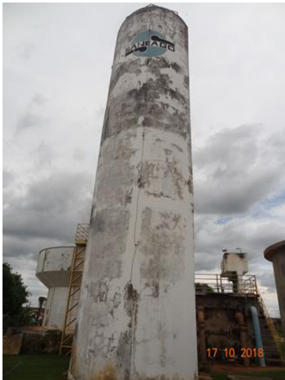
Foto 09 - REL da ETA com presença de pintura desgastada e infiltração.
