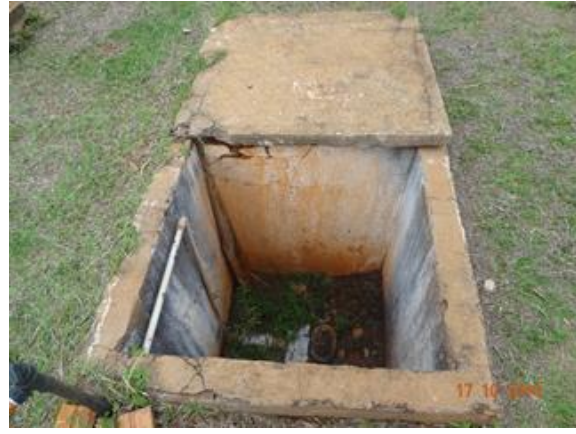
Foto 6 - RAP da ETA com caixas de inspeção, passagem e ou medição com tampas inadequadas.
