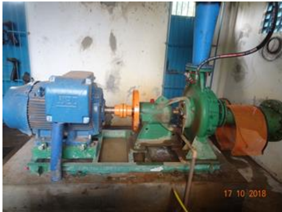
Foto 1 - Captação com vazamento no conjunto moto-bomba.
