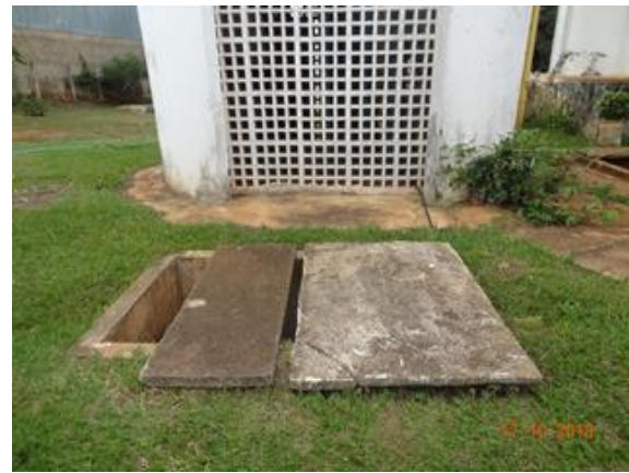
Foto 08 - REL da ETA com caixas de inspeção, passagem ou medição com tampas inadequadas.
