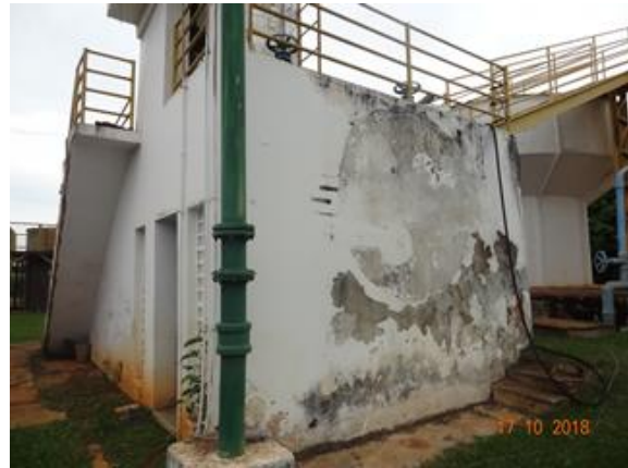
Foto 2 - ETA com presença de infiltrações na parte externa dos filtros convencionais.
