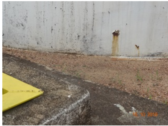
Foto 4 - RAP com pintura desgastada e corrosão.
