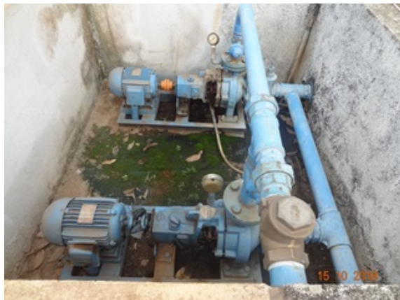
Foto 1 - EEAT com pintura desgastada.
