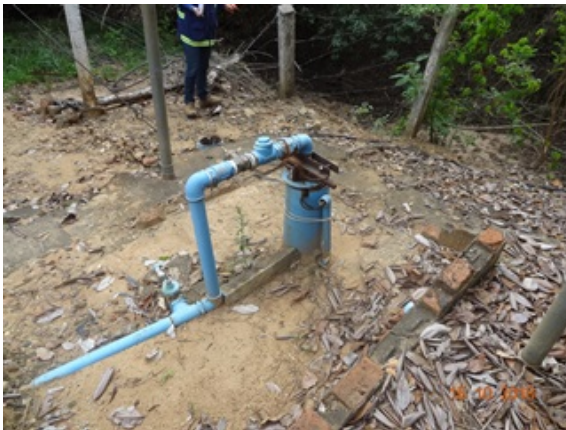
Foto 5 - Poço 02 com cerca danificada
