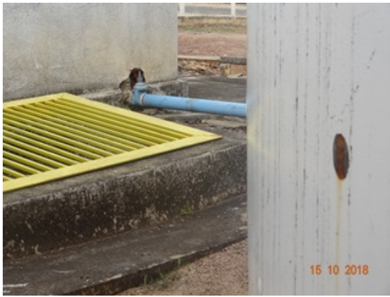
Foto 3 - RAP com pintura desgastada e corrosão.
