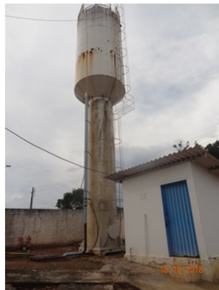
Foto 2 - REL com pintura desgastada e corrosão.
