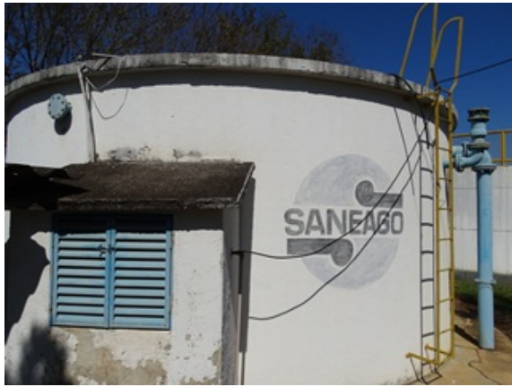
Foto 3 - Ausência de guarda-corpo.
