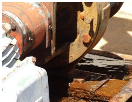
Foto 2 -Vazamento conjunto moto-bomba.
