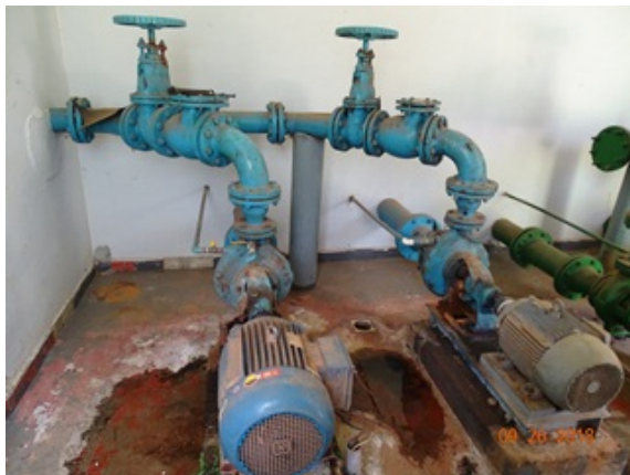
Foto 3 - Vazamento no conjunto moto-bomba.
