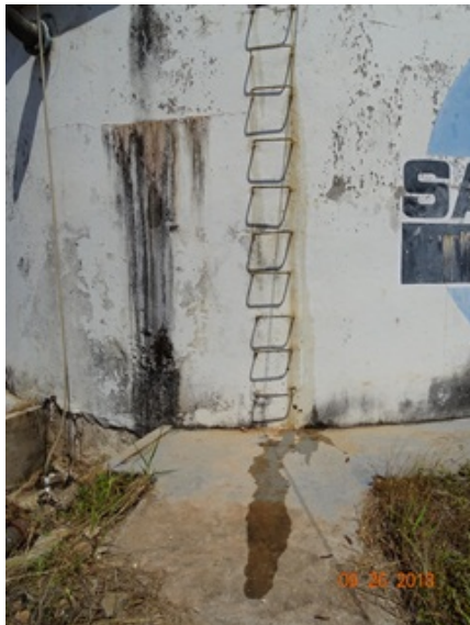
Foto 5 - Presença de infiltração.
