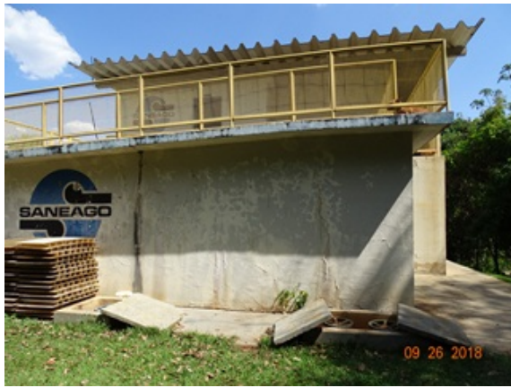
Foto 1 - Presença de infiltração. Pintura desgastada.
