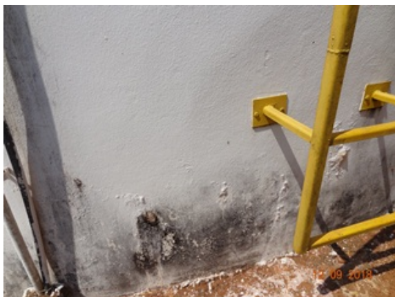
Foto 1 - Presença de infiltrações e eflorescências RAP/R 02
