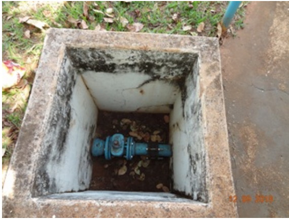
Foto 3 -Caixas de passagem sem as devidas tampas.
