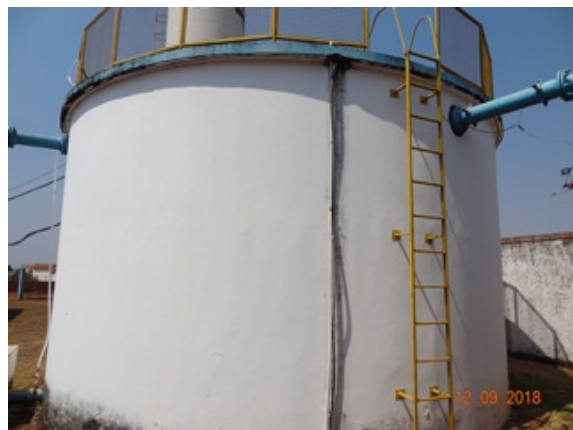
Foto 2 - Ausência de guarda-corpos RAP/R 02
