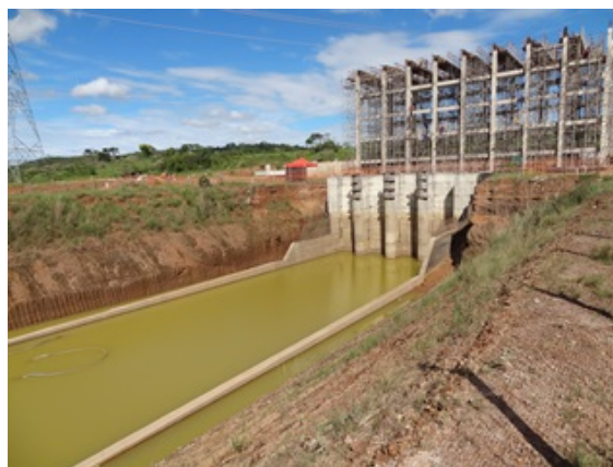
Foto 2 - Área de Captação, Bombas - SAA Corumbá IV
