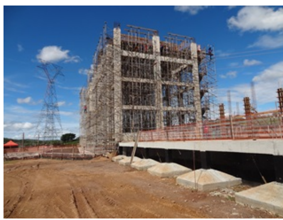
Foto 4 - Área de Captação, Bombas - SAA Corumbá IV
