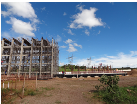
Foto 3 - Área de Captação, Bombas - SAA Corumbá IV
