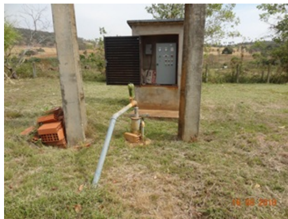
Foto 2 - Casa de quadro de comando sem pintura.
