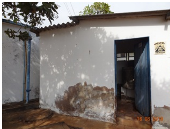
Foto 6 - Casa de tratamento com perda de revestimento e porta de acesso deteriorada.
