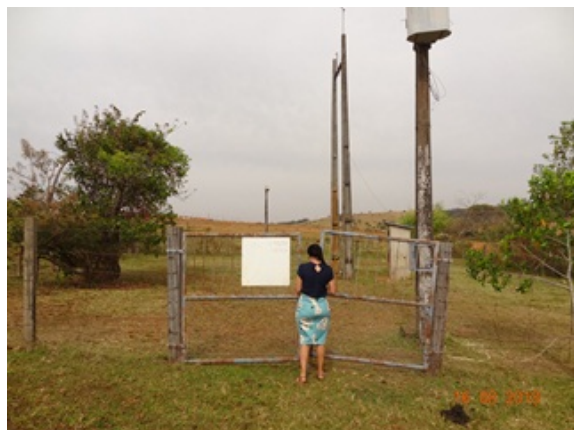
Foto 1 - Placa de sinalização do poço não permite sua identificação. .
