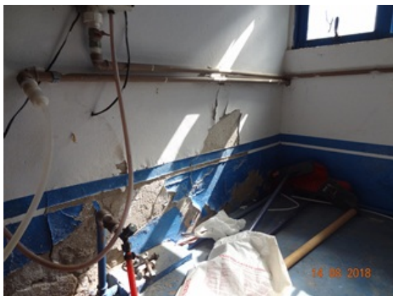
Foto 1 - Perda de revestimento e pintura desgastada.
