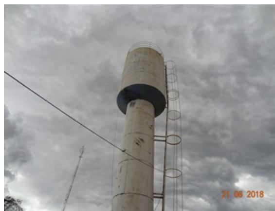
Foto 4 - Reservatório St. Vila Noca com pintura desgastada
