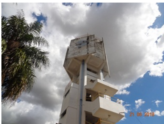
Foto 5 - Reservatório da ETA com pintura desgastada.
