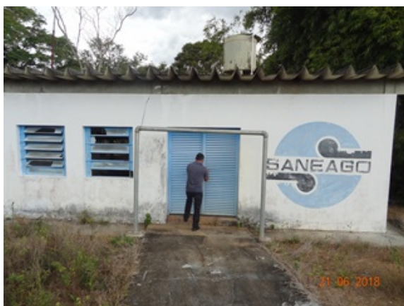
Foto 3 - Janelas quebradas na EEAB
