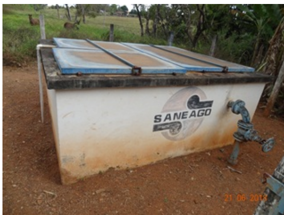
Foto 1 - Booster com pintura desgastada
