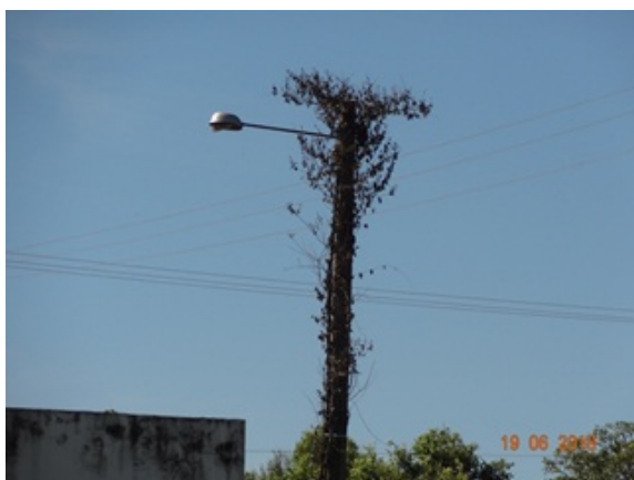
Foto 5 - Poste de iluminação do pátio danificado
