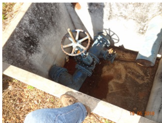
Foto 6 - Vazamento no registro de saída
