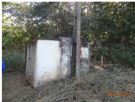
Foto 4 - Abrigo do quadro de comando com perda de revestimento e pintura desgastada
