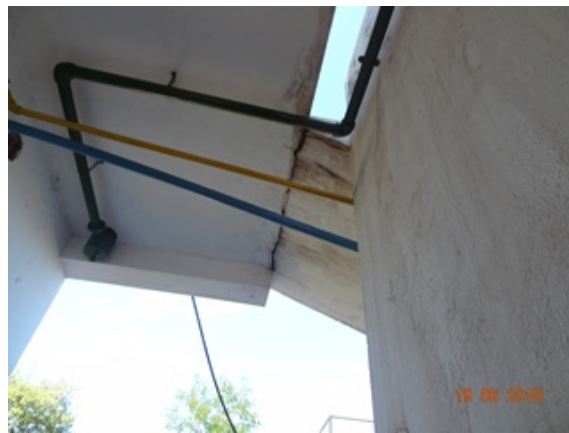
Foto 2 - Floculadores com pintura desgastada e infiltração, eflorescências e rachadura.
