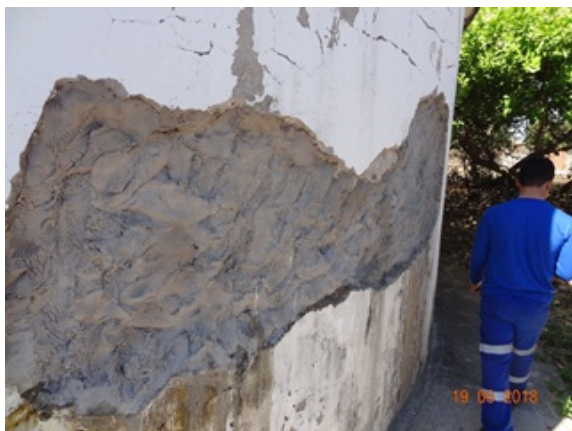
Foto 3 - reservatório com infiltração e eflorescências e pintura desgastadas.
