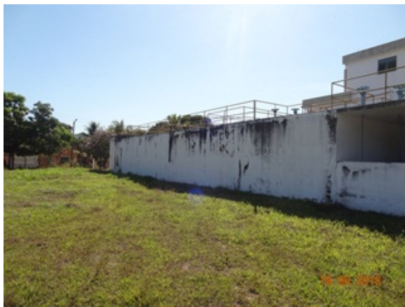
Foto 1 - Desgaste da pintura, infiltração e eflorescências na ETA
