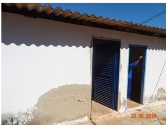
Foto 5 - Perda de revestimento
