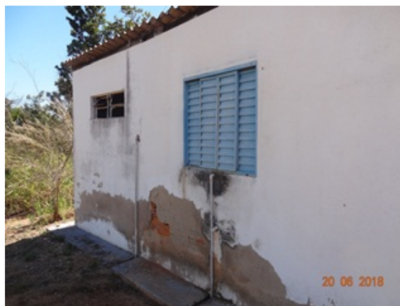
Foto 4 - Perda de Revestimento.
