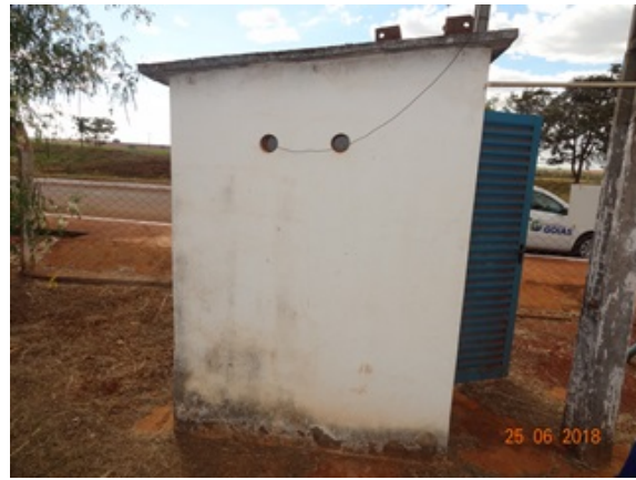
Foto 4 - Pintura desgastada da edificação da área do poço.
