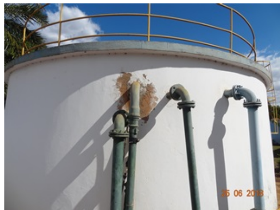
Foto 2 - Pintura desgastada do RAP e com perda de revestimento.
