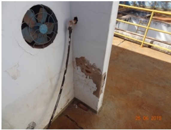
Foto 3 - Casa de química com perda de revestimento e pintura desgastada.
