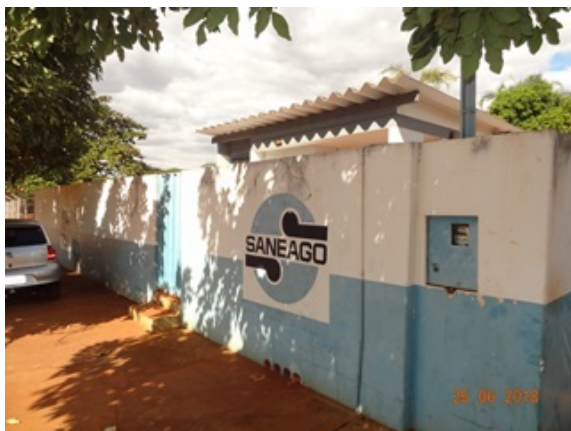
Foto 1 - Pintura desgastada das edificações do Distrito.
