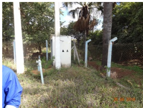
Foto 6 - Pintura desgastada da edificação da área do poço.
