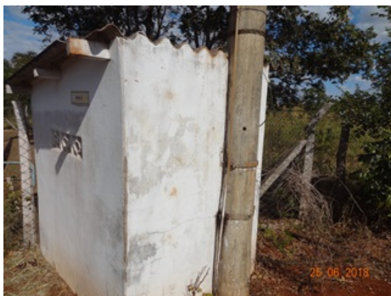
Foto 5 - Pintura desgastada da edificação da área do poço.
