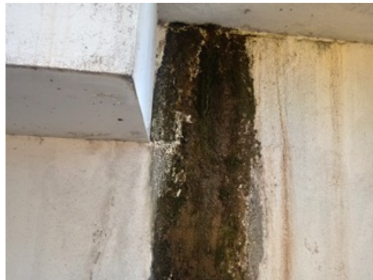
Foto 4 - ETA/II Infiltrações, eflorescências nas paredes dos floculadores.
