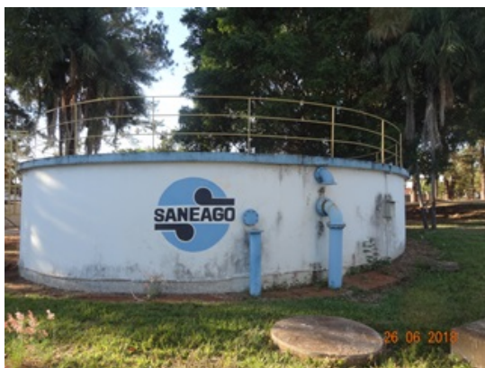
Foto 7 - ETA/I/RAP com pintura desgastada.
