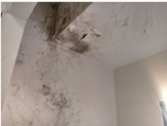
Foto 5 - ETA/II Casa de química com eflorescências, perda de revestimento e infiltrações.
