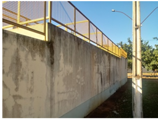
Foto 2 - ETA/I Infiltrações nas paredes dos floculadores.
