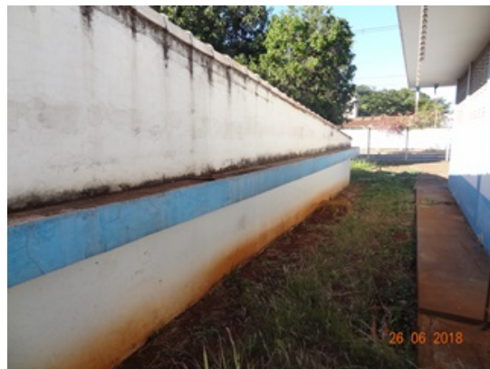
Foto 6 - ETA/I/RSE com pintura desgastada.
