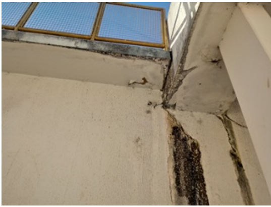
Foto 1 - ETA/I Infiltrações na calha parshal.
