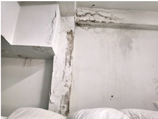
Foto 3 - ETA/I Casa de química com infiltrações e eflorescências.
