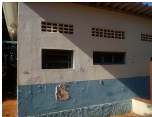
Foto 8 - EEAB/Captação com pintura desgastada das edificações.
